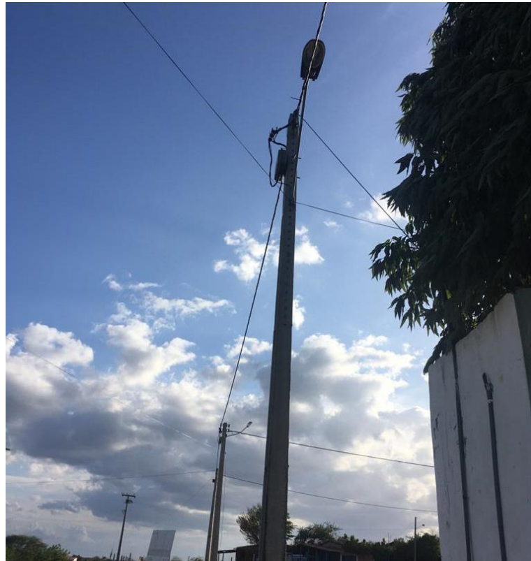
Figura 26 - Luminária Mal Direcionada
