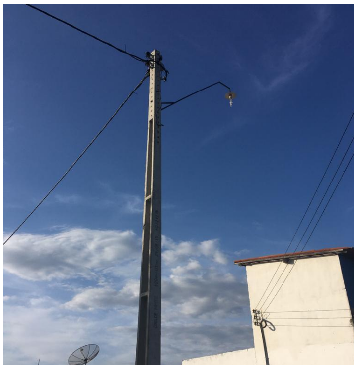
Figura 23 - Iluminação Ineficiente (A luminária não direciona o fluxo luminoso)
