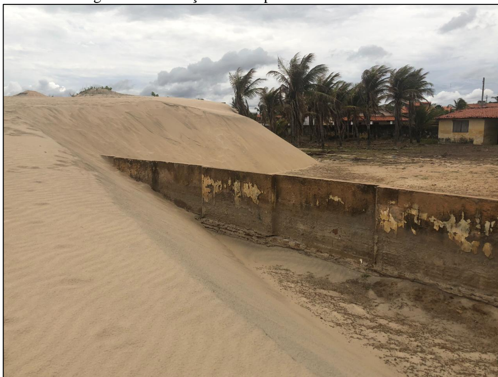
Figura 15 – Avanço da duna para dentro da residência.
