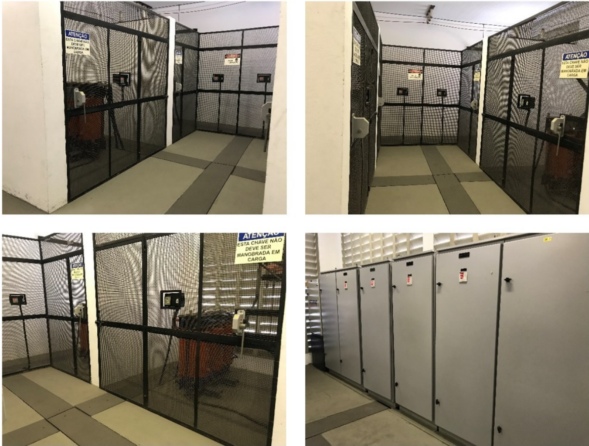
Figura 7 – Subestação abrigada do TCE-CE
