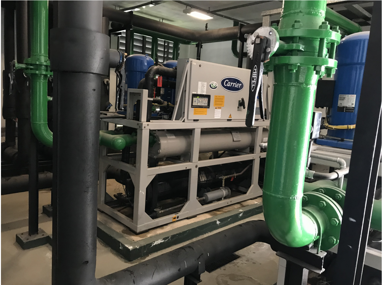
Figura 8 – Sistema de chiller do TCE-CE
