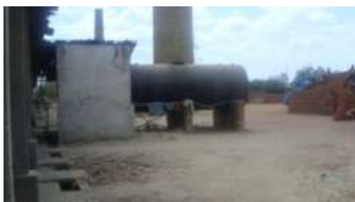
Figura 10. Tanque de armazenamento do óleo BPF no município de Sobral. Fonte própria, 2010.
