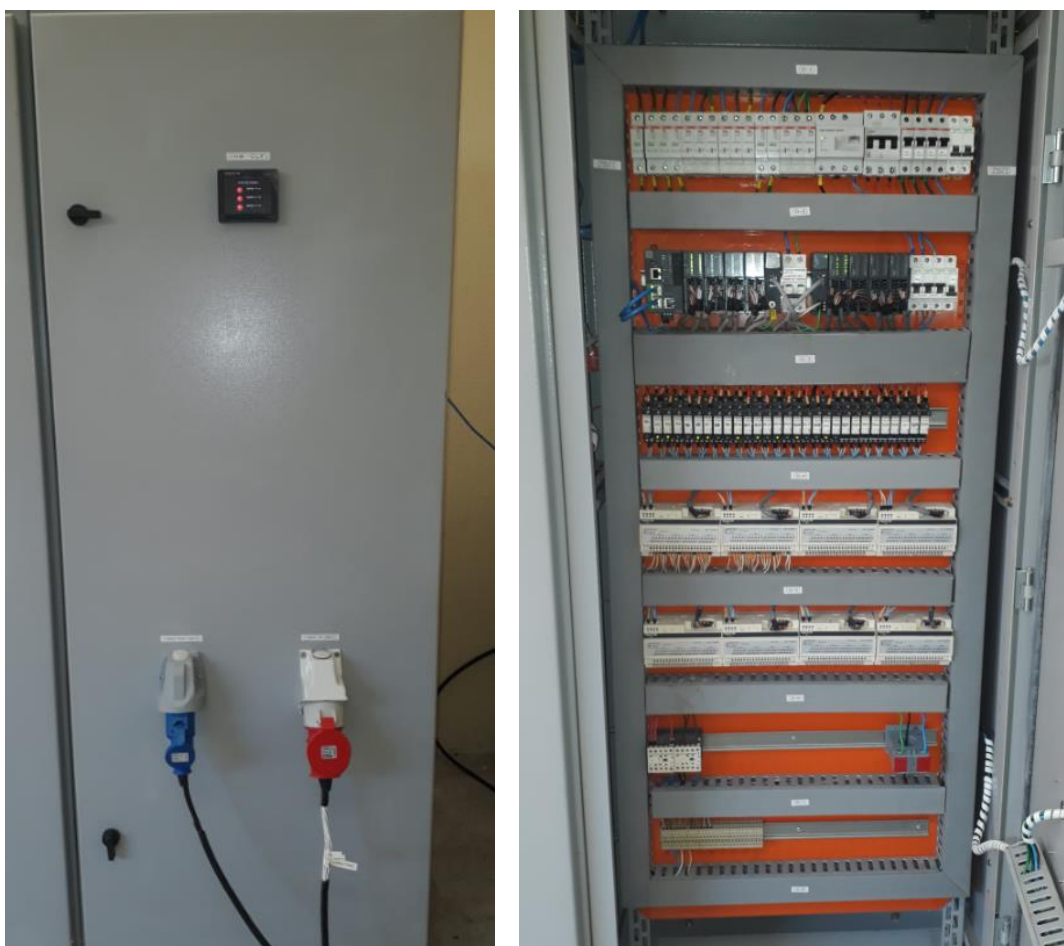
Figura 27 - QD Geral - Microrrede: equipamentos de comando
