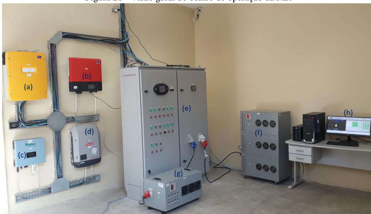
Figura 20 - Visão geral do centro de operação da MR
