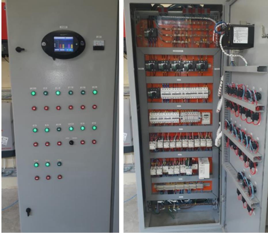
Figura 25 - QD Geral - Microrrede: equipamentos de proteção e manobra
