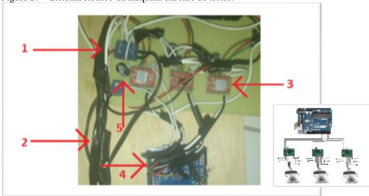
Figura 27 – Sistema elétrico da máquina em fase de testes.
