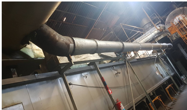
Imagem 1 - Tubulação sem Revestimento Térmico na Lito 04
