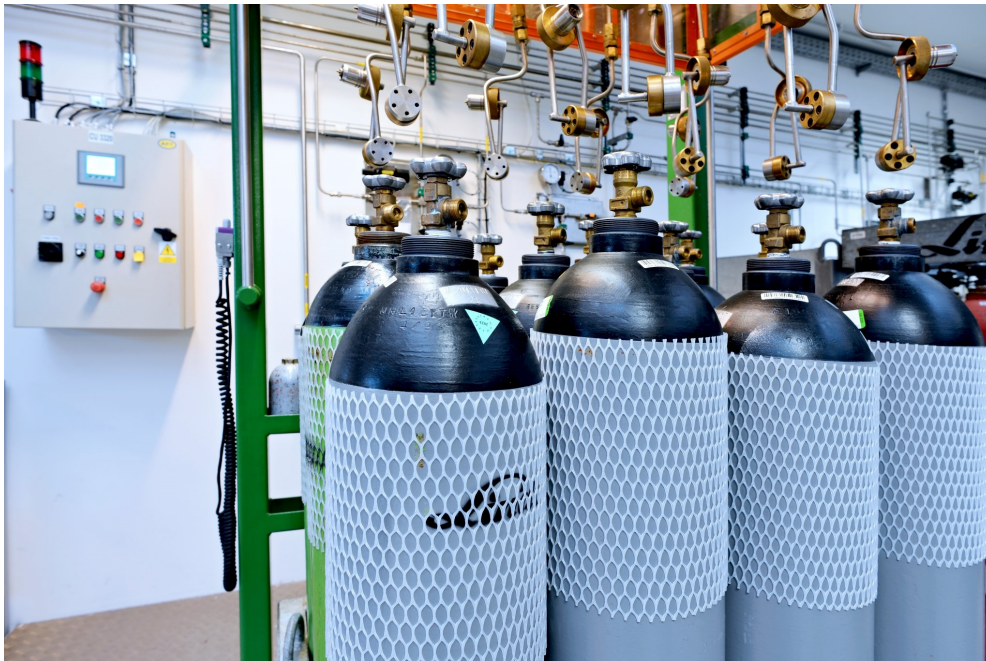
Figura 10 - Estação de enchimento de gases, modal Packaged
