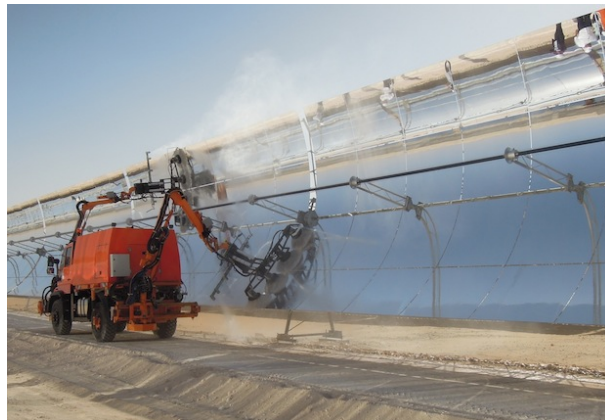
Figura 9 – Limpeza dos coletores parabólicos na usina Shams I.
