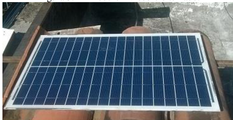
Figura 3.1 – Módulo FV sobre o telhado.
