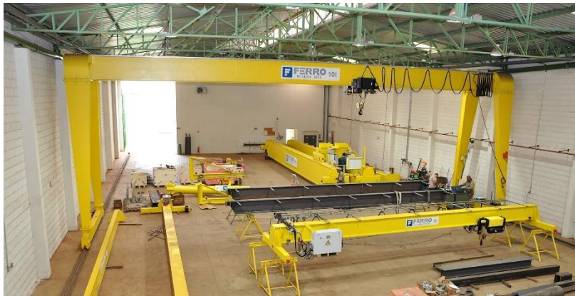
Figura 01 – Ponte rolante apoiada e univiga com talha
