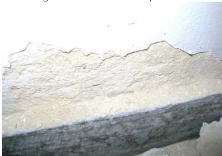
Figura 8 - Descolamento com pulverulência
