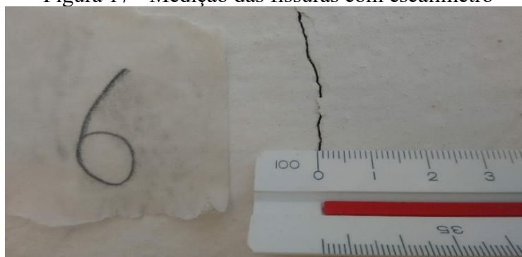
Figura 17 - Medição das fissuras com escalímetro
