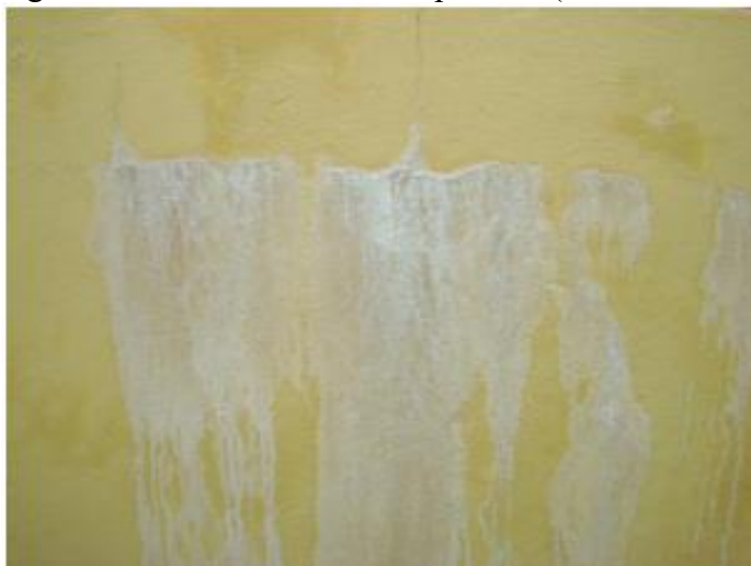
Figura 5 - Pó branco sobre a superfície (Eflorescência)
