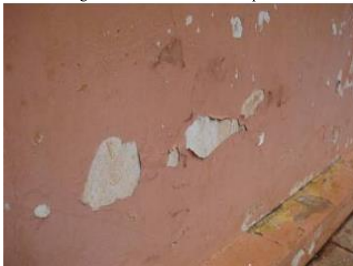
Figura 12 - Descolamento da pintura
