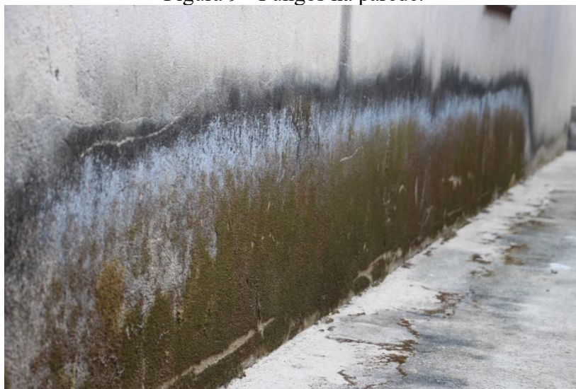
Figura 9 - Fungos na parede.
