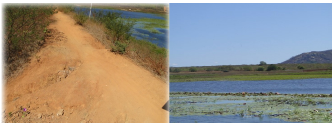
Figura 1 – Vegetação nos taludes de montante e jusante (fotografia à esquerda) e presença excessiva de macrófitas aquáticas
