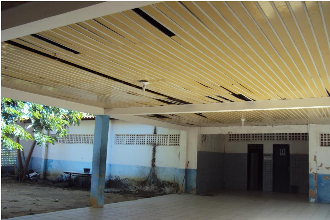
Figura 12: Forro do teto do pátio do CREAS SER V, prestes a cair como o que caíra na entrada.
