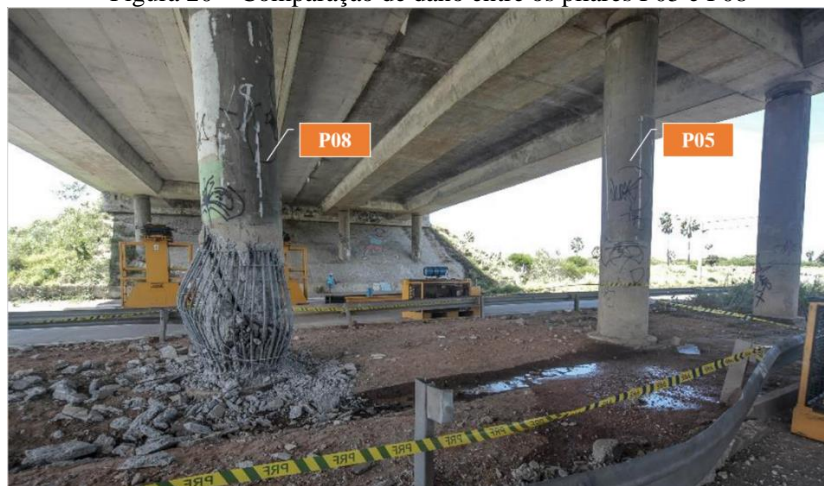
Figura 20 – Comparação de dano entre os pilares P05 e P08
