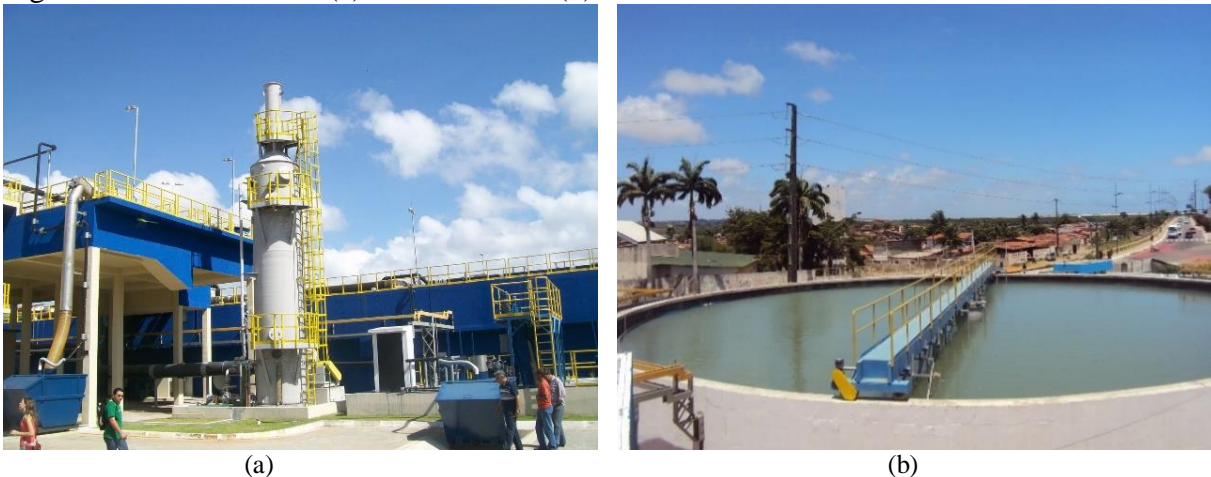
Figura 7 - ETE de Baldo (a) Reator UASB (b) Decantador Secundário
