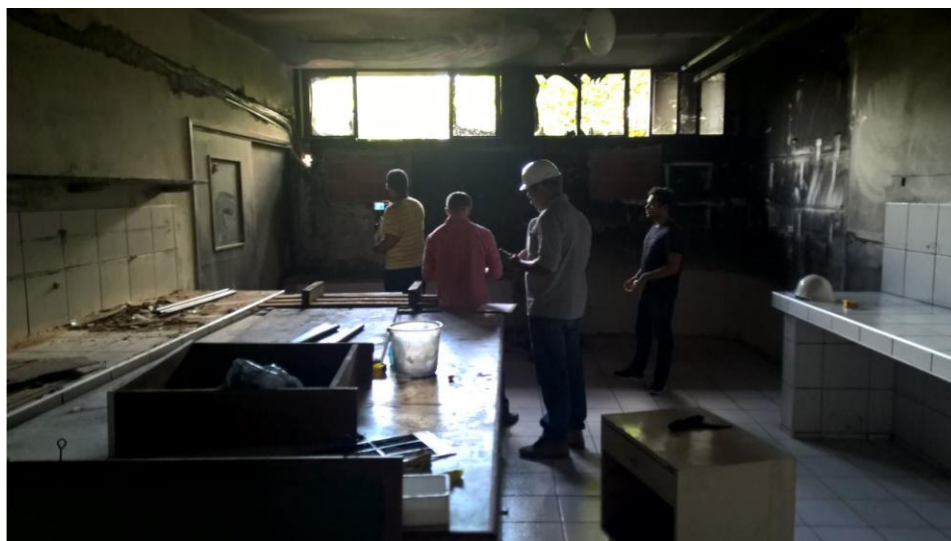
Figura 3 - Laboratório do bloco 907, danificado pelo incêndio
