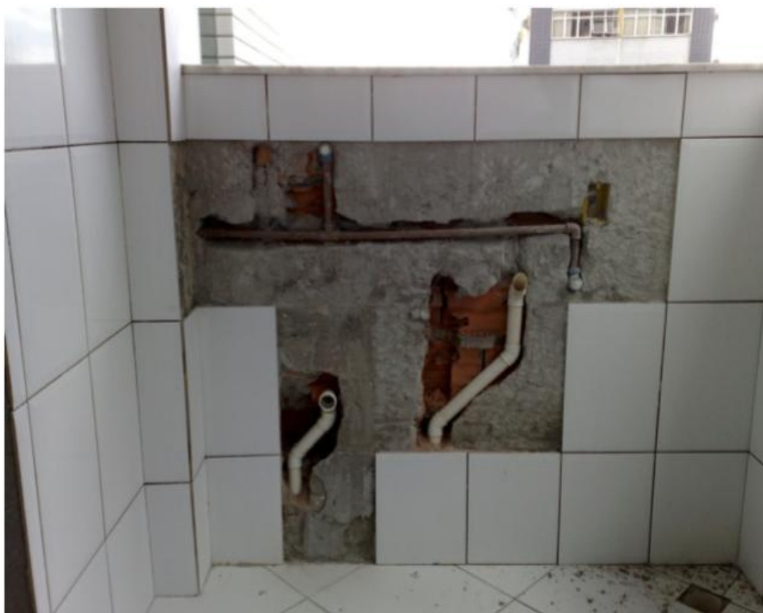
Figura 4 - Interferência entre instalações hidráulicas, alvenaria e acabamento em um sistema construtivo tradicional
