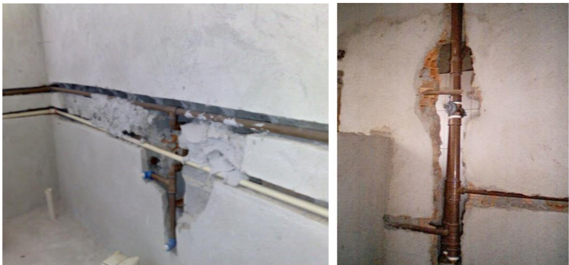
Figura 2 - Interferência entre instalações hidráulicas e alvenaria em um sistema construtivo tradicional
