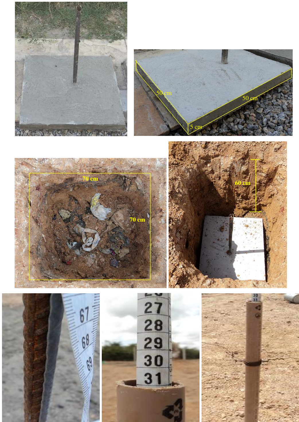
Figura 24 - Vista da placa de recalque e de sua instalação na CE, 2011
