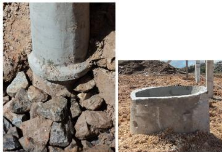
Figura 13 - Vista do sistema de proteção do dreno para líquidos e vista no nível do terreno, 2011
