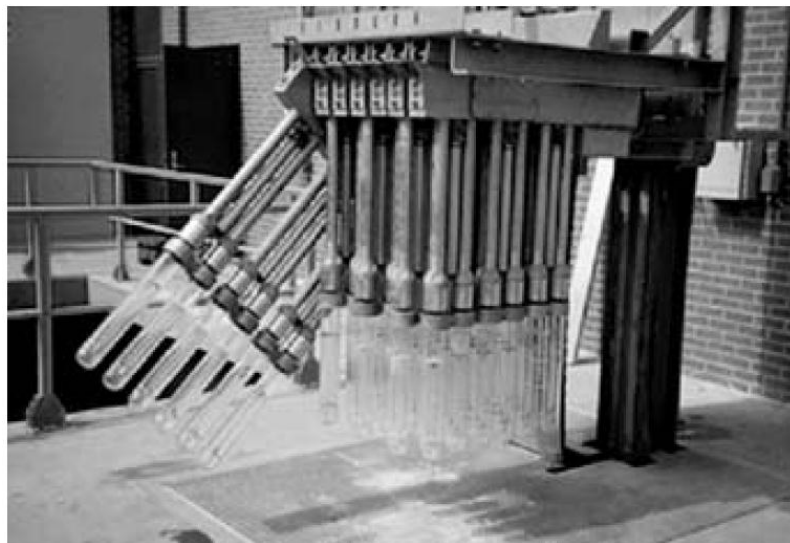
Figura 8 – Unidade de desinfecção por UV de efluentes extravasados de um sistema combinado de coleta de esgoto e águas pluviais.
