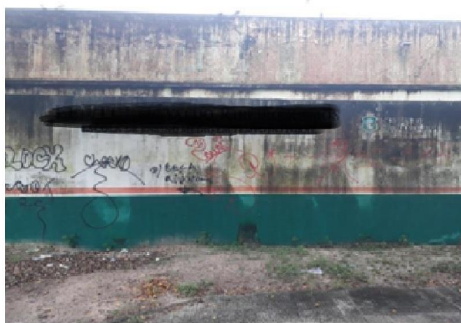
Figura 23 - Muro frontal da Escola de Ensino Médio em Tempo Integral no Bairro Carlito Pamplona
