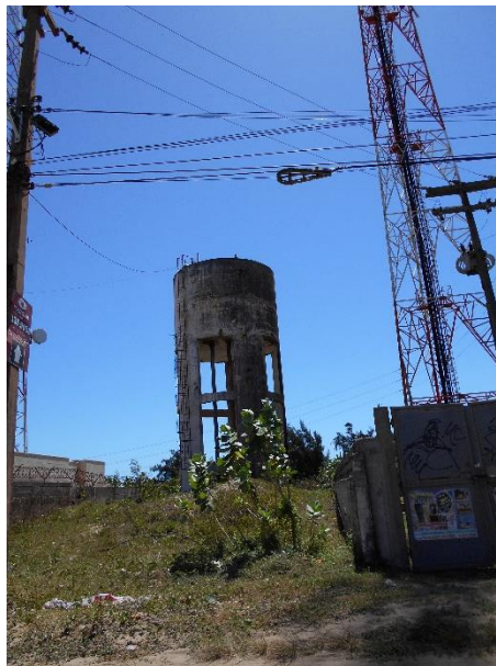
Figura 19 – Reservatório da CAGECE localizado na subárea centro
