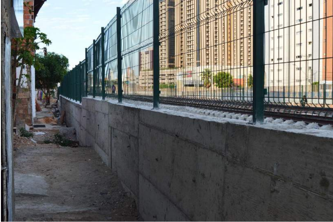
Imagem 5- Foto do muro do Trilho dia 22 de novembro do 2018. Registro próprio.
