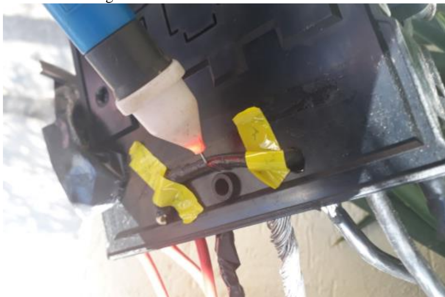
Figura 9 – Medidor Curto Circuitado
