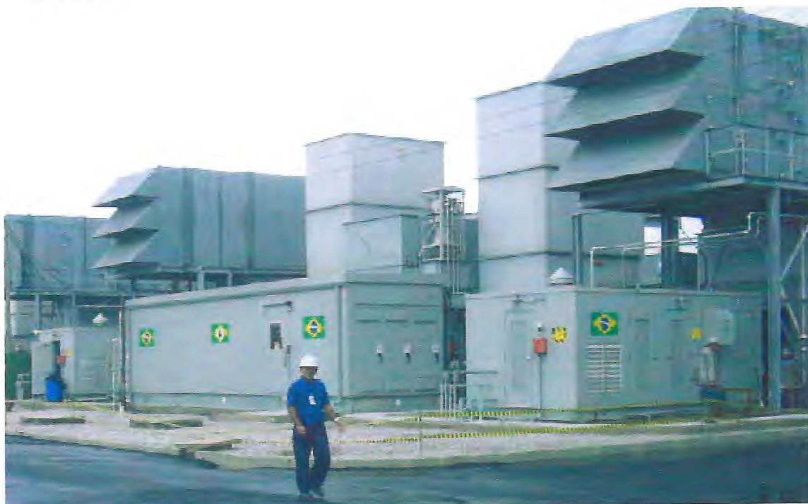
Figura 3.4 – Unidade geradora e equipamentos auxiliares Fonte: Foto da termoelétrica em estudo
