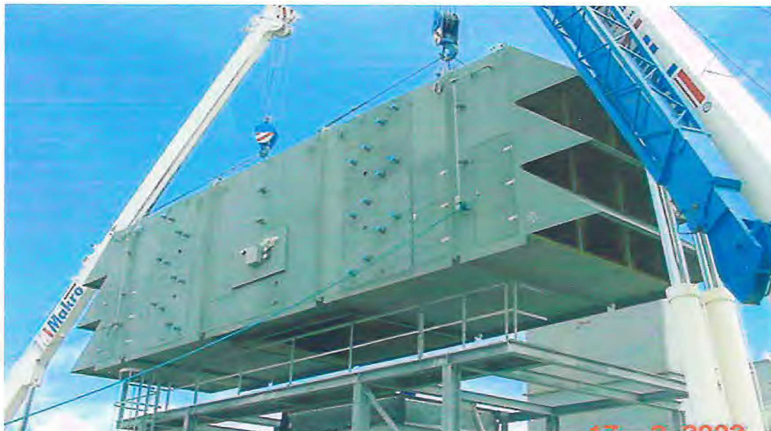
Figura 3.2 - Casa de filtro Fonte: Foto da termoeletrica em estudo
