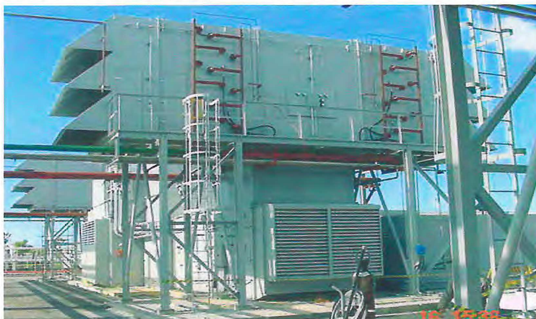
Figura 3.3 - Casa de filtro com as tubulações de entrada e saída de água gelada Fonte: Foto da planta
