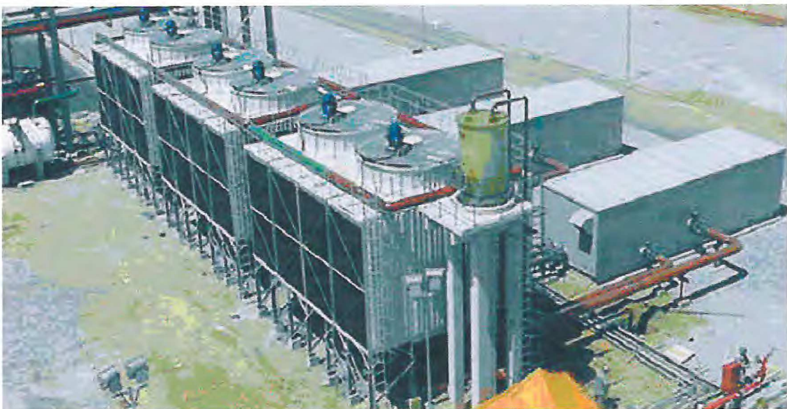
Figura 3.1 - Sistema de resfriamento chiller Fonte: Foto da termoelétrica em estudo
