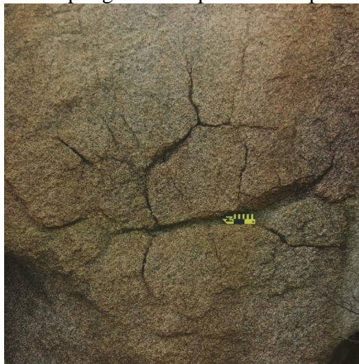
Figura 47 – Rachaduras poligonais incipiente em superfície lateral boulder .
