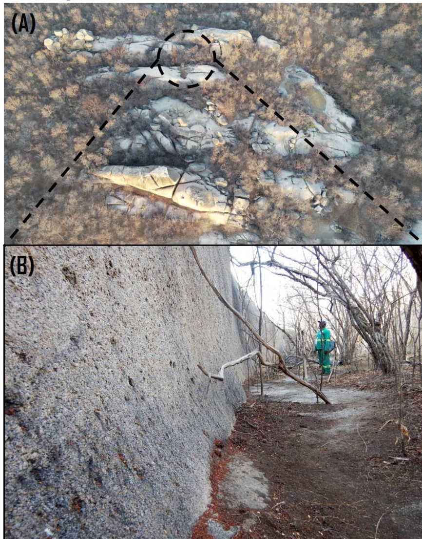
Figura 41 – (A) Fissuras alargadas em afloramento rochoso; (B) Flared slope desenvolvido no interior da fissura.
