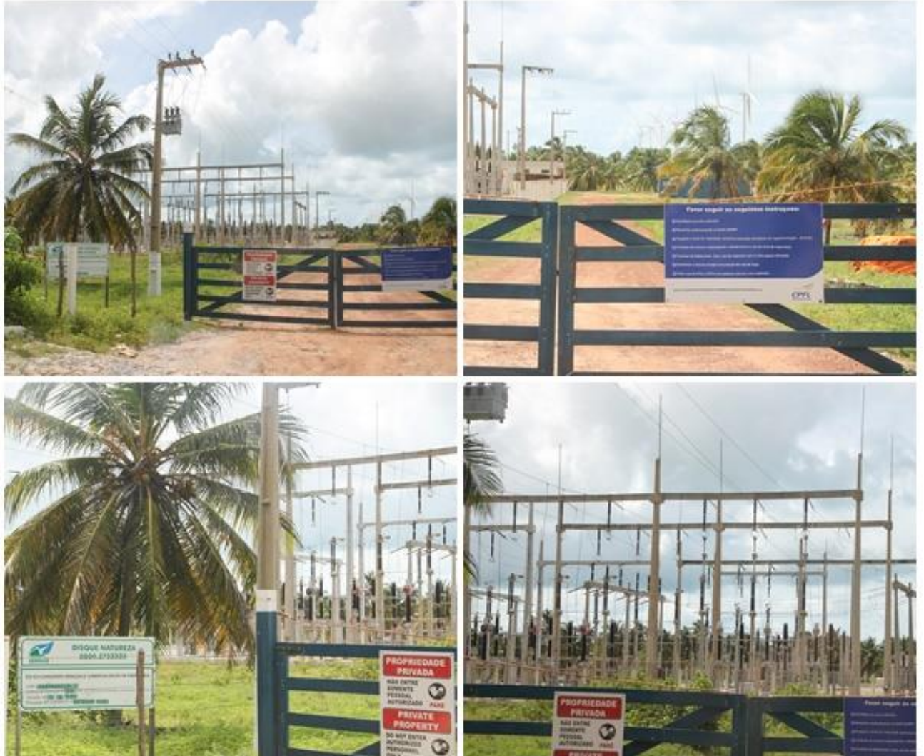
Figura 23 – Entrada da usina do parque eólico de Icaraizinho em Amontada
