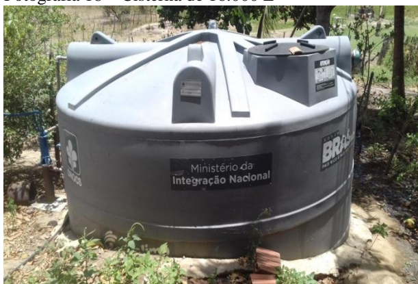
Fotografia 18 – Cisterna de 16.000 L
