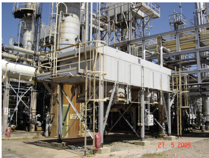
Figura 1.11: Condensador de topo (vaso retangular) da torre desbutanizadora da UPGN.
