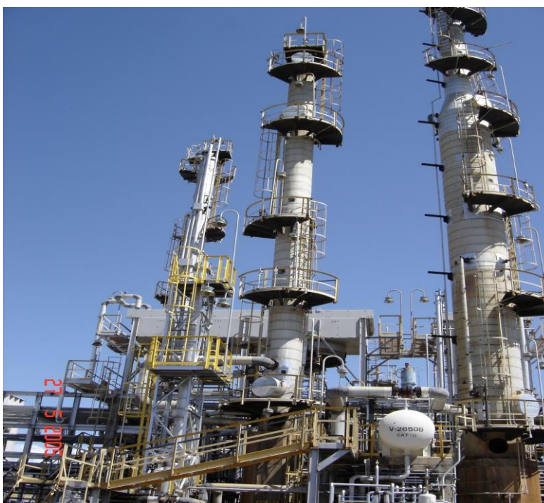
Figura 1.9: UPGN da LUBNOR com a torre desbutanizadora ao centro.
