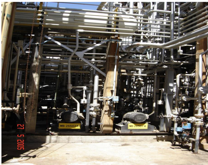
Figura 1.10: Vaso acumulador (na parte superior) e bombas (principal e reserva) de refluxo da UPGN da LUBNOR.
