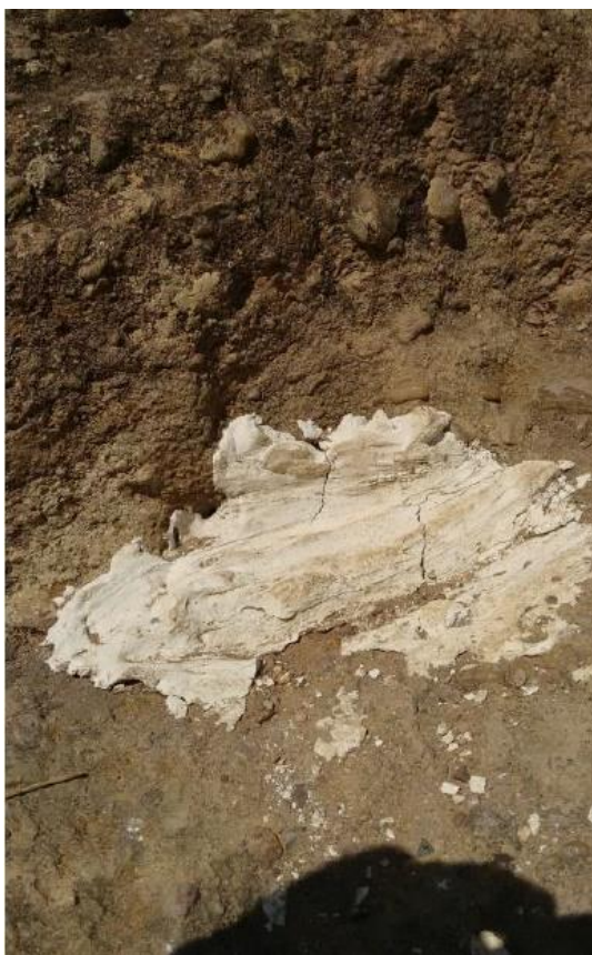
III - Presença de fissuramentos no curativo de gesso, demonstrando que houve movimentação no corpo da ponte.
