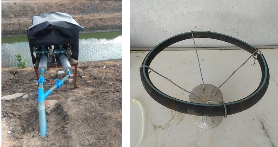
Figura 6 – Sopradores radiais de ar e mangueira porosa.
