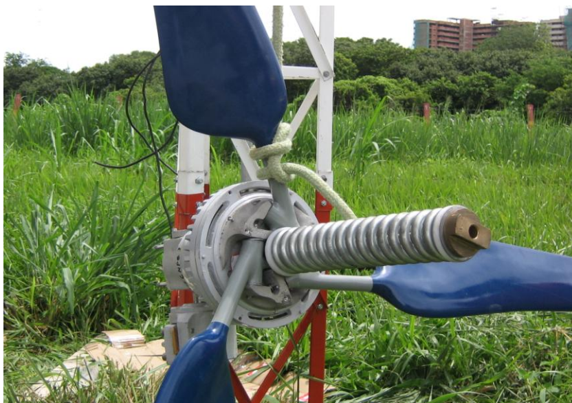
Figura 4.5 – Aerogerador com máquina de ímã-permanente utilizado no experimento.
