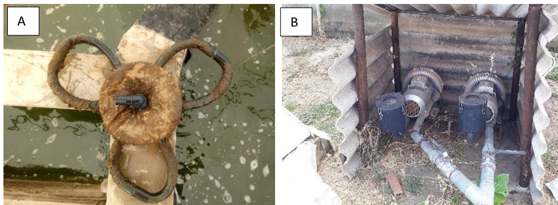
Figura 29 – Aerotubes acoplados em uma estrutura de concreto (A) e sopradores de 7,5 CV utilizados na aeração dos raceways (B).
