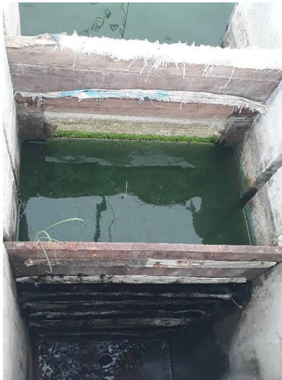
Figura 39 - Comporta de drenagem do viveiro de engorda aberto.
