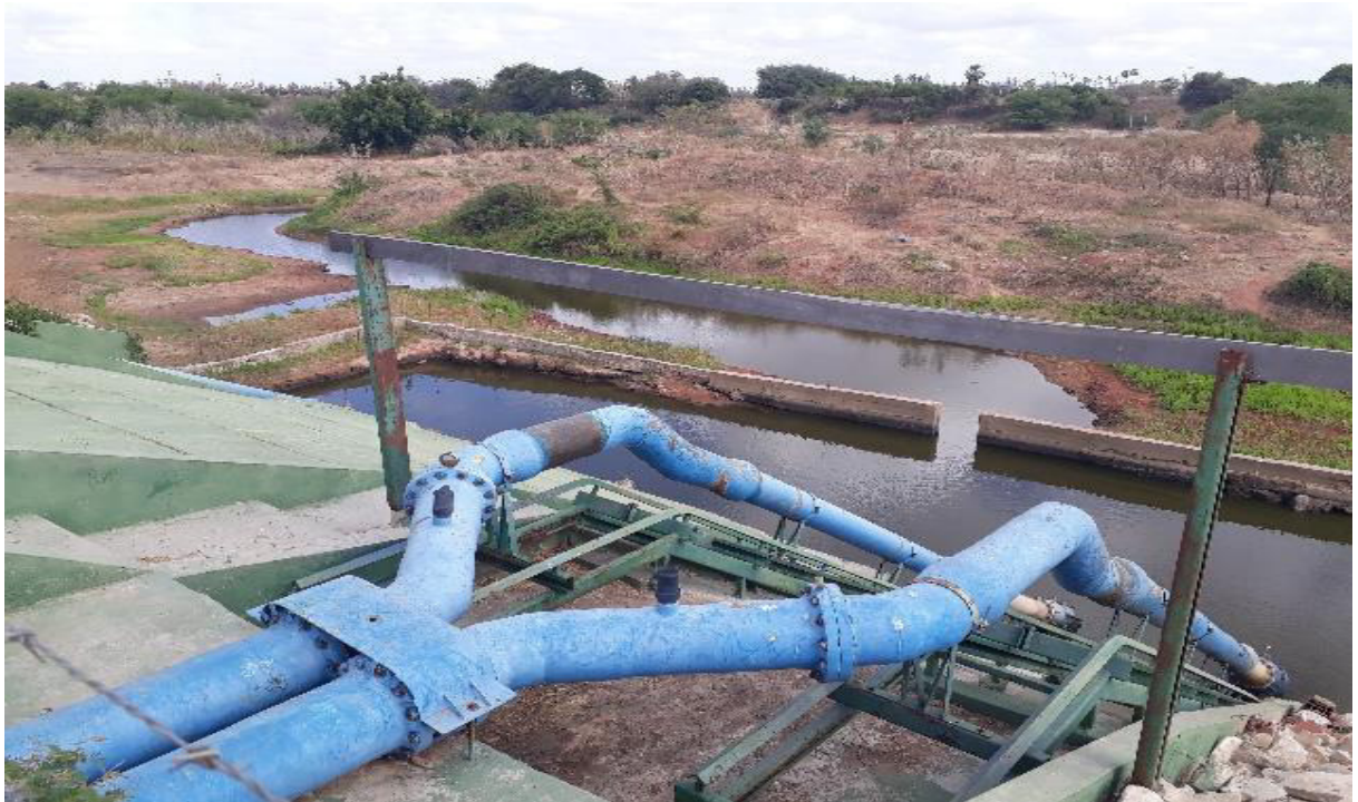
Figura 7 - Eletrobombas que captam a água do Rio Jaguaribe.
