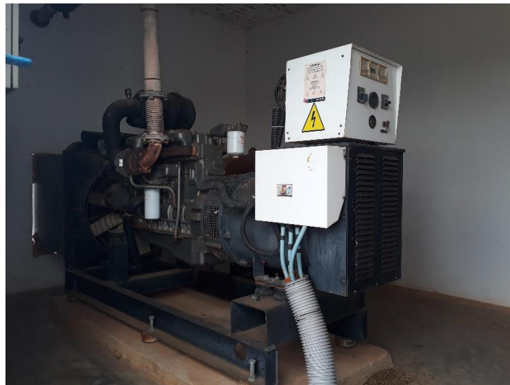
Figura 9 – Grupo gerador, com potência de 150 kVA.
