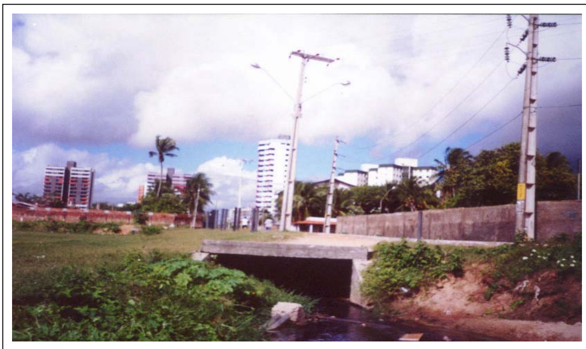
Figura 32 - Galeria pluvial ligada a lagoa do Papicu sendo utilizada no escoamento de efluentes domésticos .
