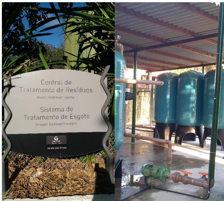
Figura 35 – Central de Tratamento de Resíduos dentro do Resort.
