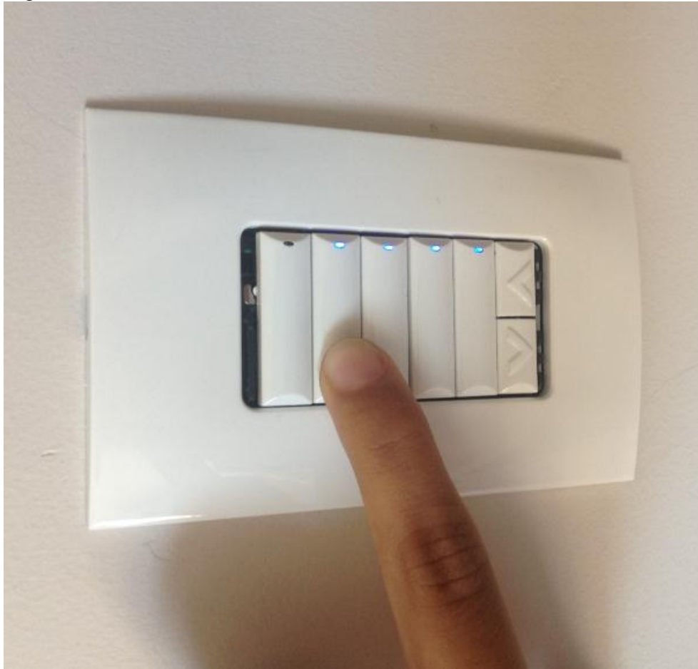
Figura 18 – Pulso na tecla dois do tecladimmer
