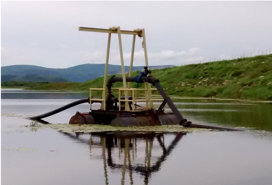
Figura 21 – Foto do motor de 50CV acoplado a uma bomba responsável pela captação dá água do reservatório e transporte até a estação de tratamento de Frecheirinha. Motor fixado a uma balsa flutuante.
