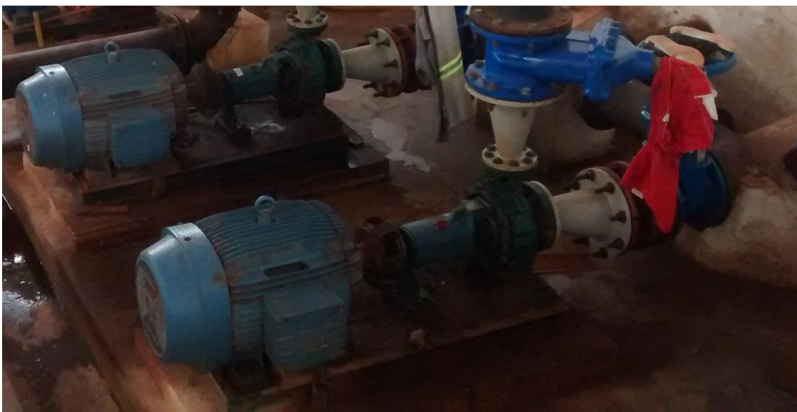
Figura 22 – Motor de 60CV responsável pela captação da água tratada e do transporte até o reservatório de distribuição da unidade de Frecheirinha. Foto do motor utilizado e motor reserva.
