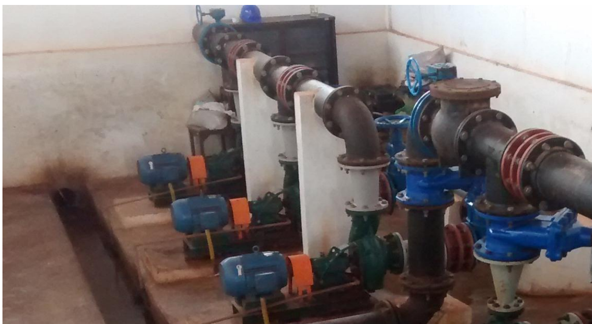
Figura 24 – Foto dos Motores de 15CV responsáveis por realizar a limpeza dos filtros na unidade de Frecheirinha. Dois motores utilizados e um motor reserva.
