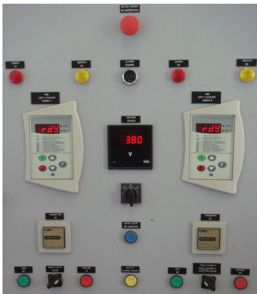
Figura 32 – Foto do painel de controle com soft-starters na unidade consumidora de Frecheirinha.
