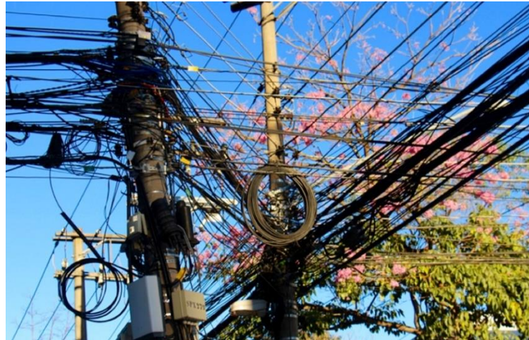
Figura 2: Excesso de cabos de telecomunicação em postes
