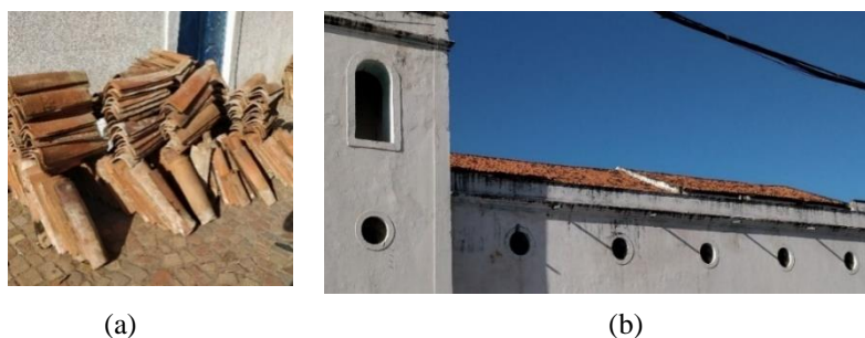
Figura 7 – (a) Telhas cerâmicas da Igreja de Nossa Senhora dos Prazeres; (b) Telhado da Igreja de Nossa Senhora dos Prazeres.
