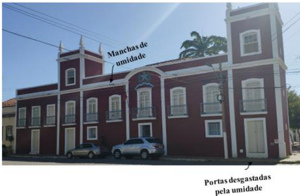
Figura A.6 – Mapeamento de danos da fachada da Câmara Municipal de Aracati.
