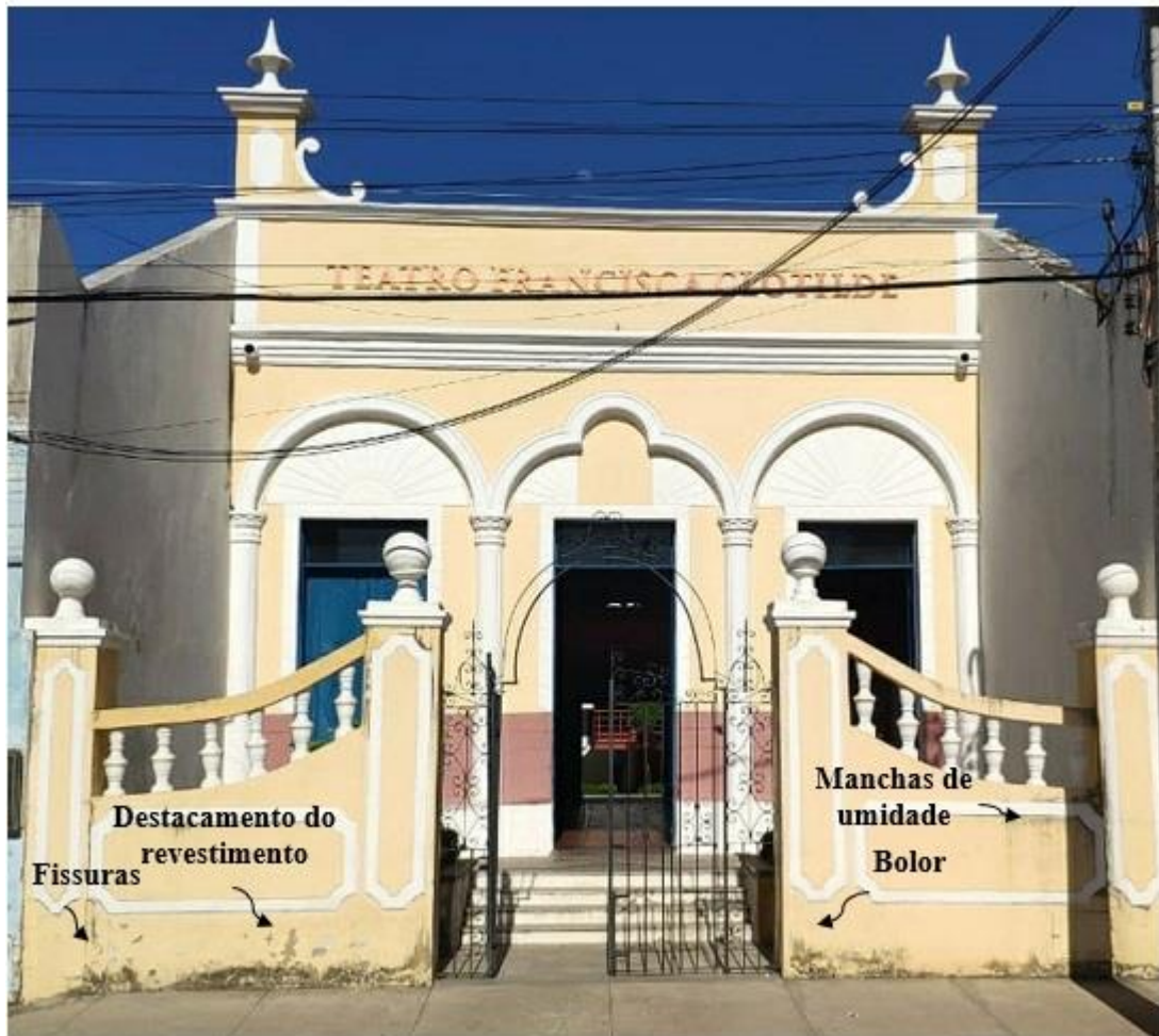
Figura A.7 – Mapeamento de danos da fachada do Teatro Francisca Clotilde.
