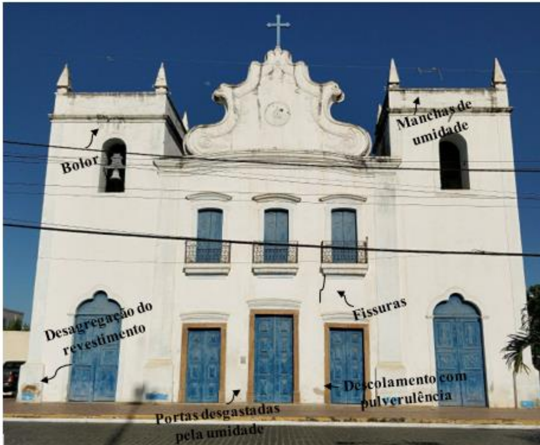
Figura A.5 – Mapeamento de danos da fachada da Igreja de Nossa Senhora dos Prazeres.
