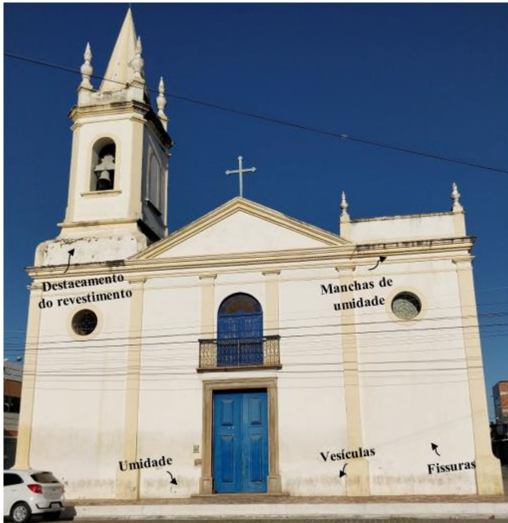
Figura A.3 – Mapeamento de danos da fachada da Igreja de Nossa Senhora do Rosário dos Pretos.
