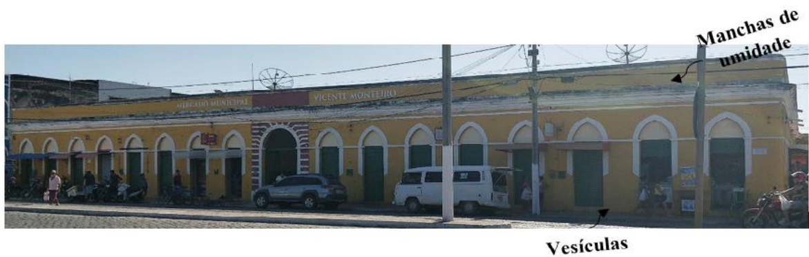
Figura A.8 – Mapeamento de danos da fachada do Mercado Público de Aracati.
