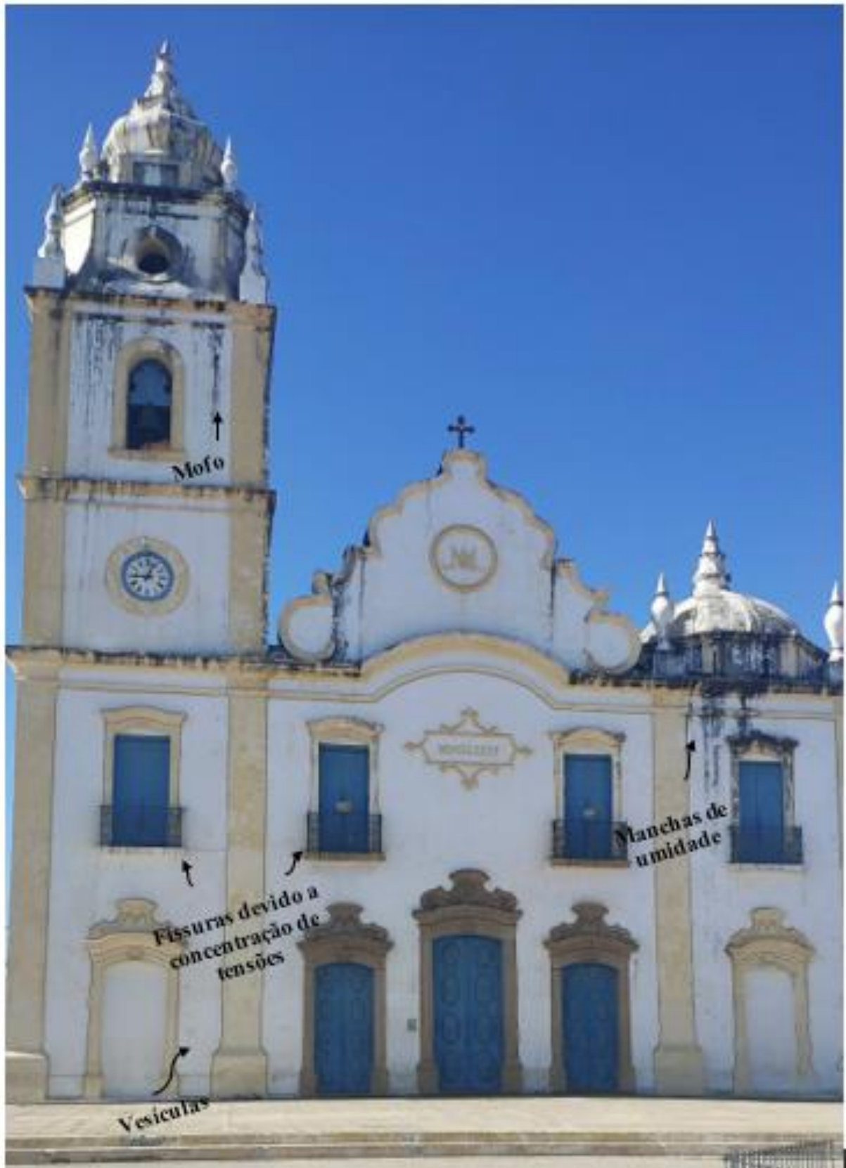
Figura A.4 – Mapeamento de danos da fachada da Igreja de Nossa Senhora do Rosário dos Brancos.
