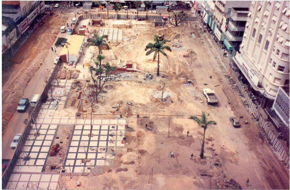
Figura 4.52 - Obra de reforma da Praça do Ferreira, 1991. Percebe-se a existência de três Palmeiras Imperiais ( Roystonea oleracea ), das quais duas ainda se encontram no lugar, próximo à Coluna da Hora.
