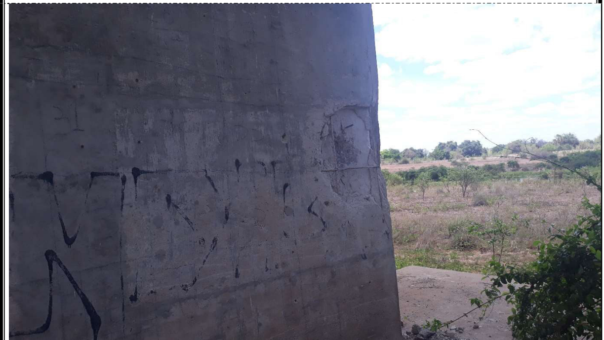
Fotográfica 10 – pilar a ser recuperado devido ao ataque.
