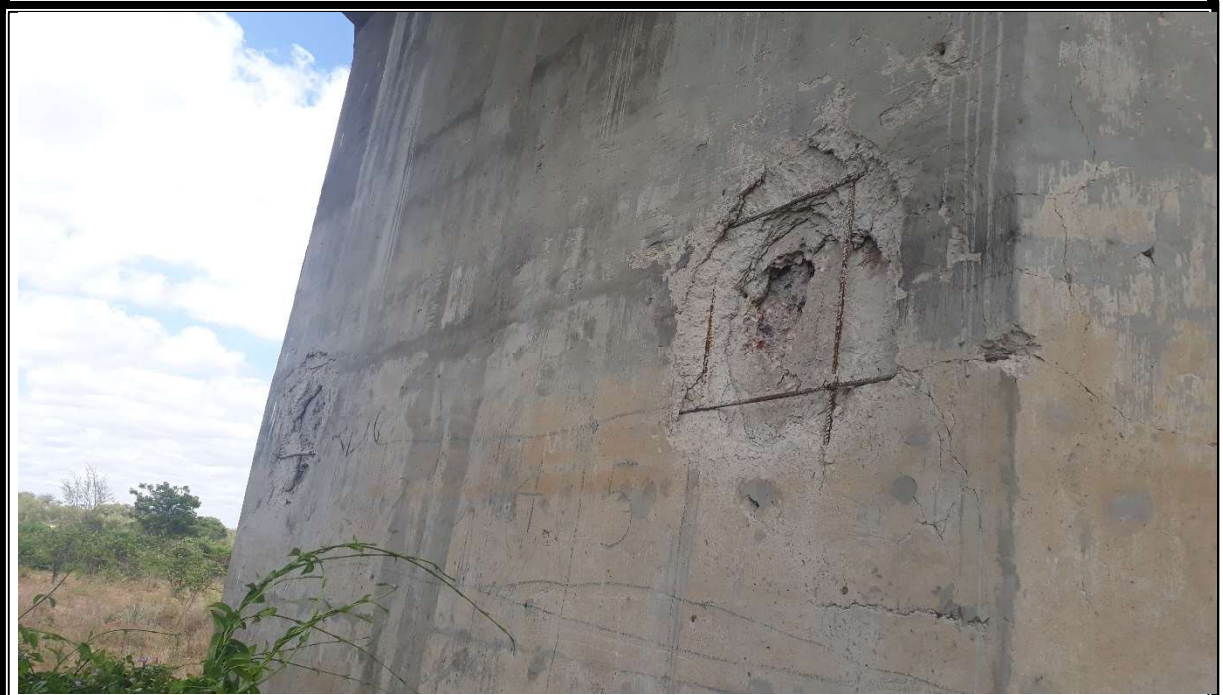
Fotográfica 09 – pilar a ser recuperado devido ao ataque.
