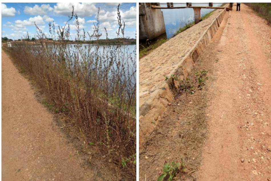
Figura 4.1 – Canaletas obstruídas, Santo Antônio de Russas.
