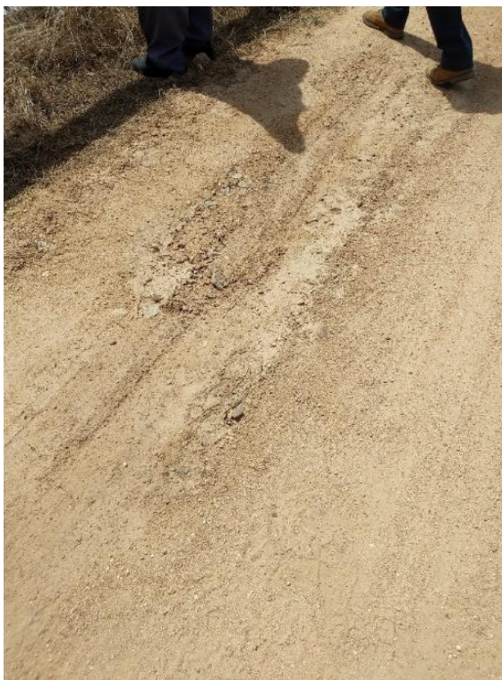
Figura 4.13 – Afundamento no coroamento, Figueiredo.
