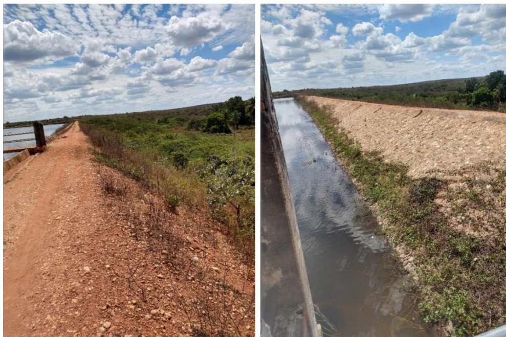
Figura 4.2 – Taludes de (a) Jusante e de (b) Montante, Santo Antônio de Russas.
