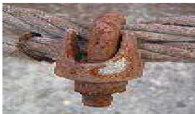
Figura 5 - Corrosão do ferro.
