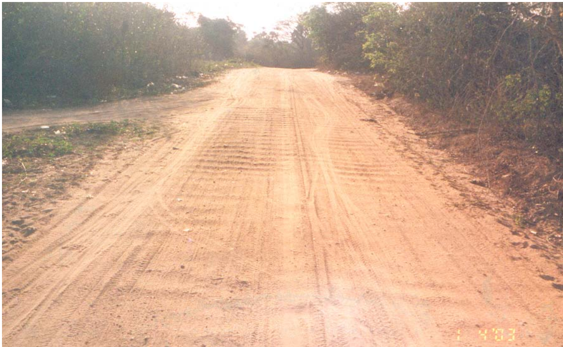
Figura 3.6: Ocorrência de Corrugações ou “Costelas de Vaca”.
