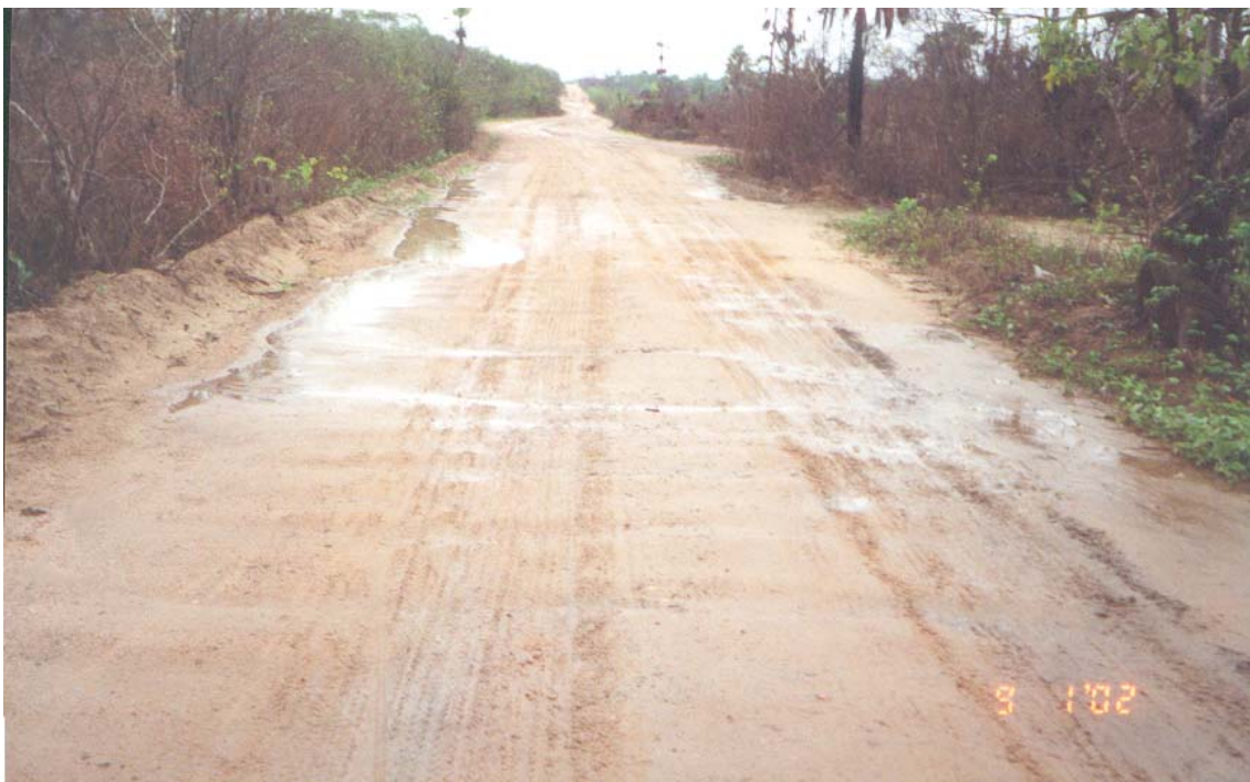
Figura 3.12: Ocorrência de Empoçamento de Água na Borda da Estrada
