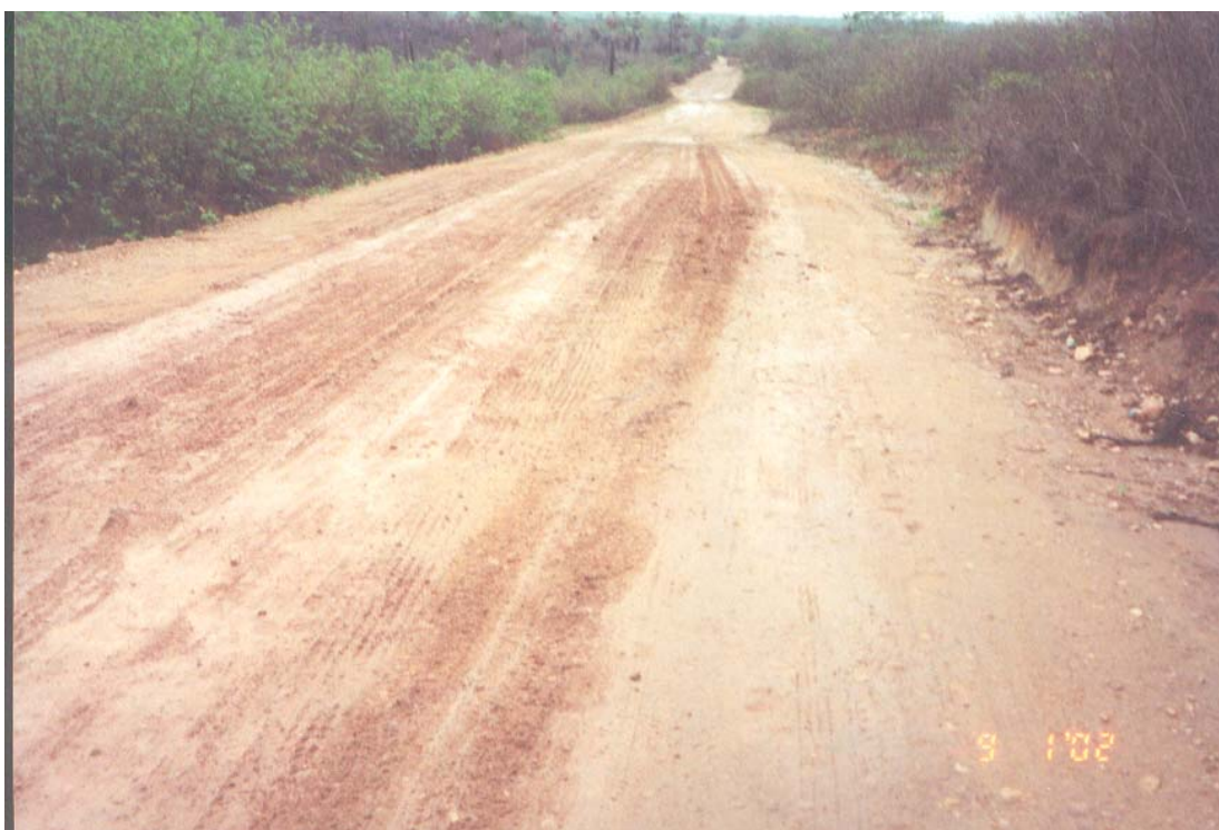
Figura 5.29: Vista de Seção Transversal Inadequada (seção “enterrada”)
