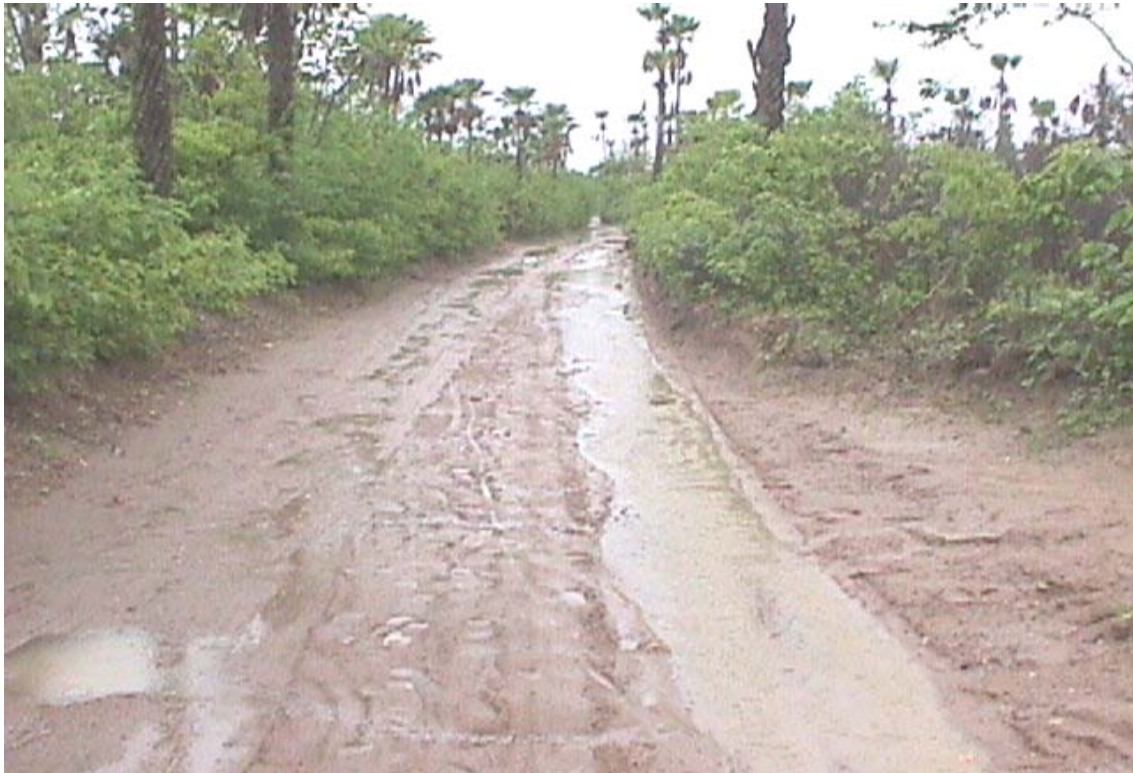
Figura 3.10: Ocorrência de Greide “Encaixado” – Seção Transversal Inadequada.
