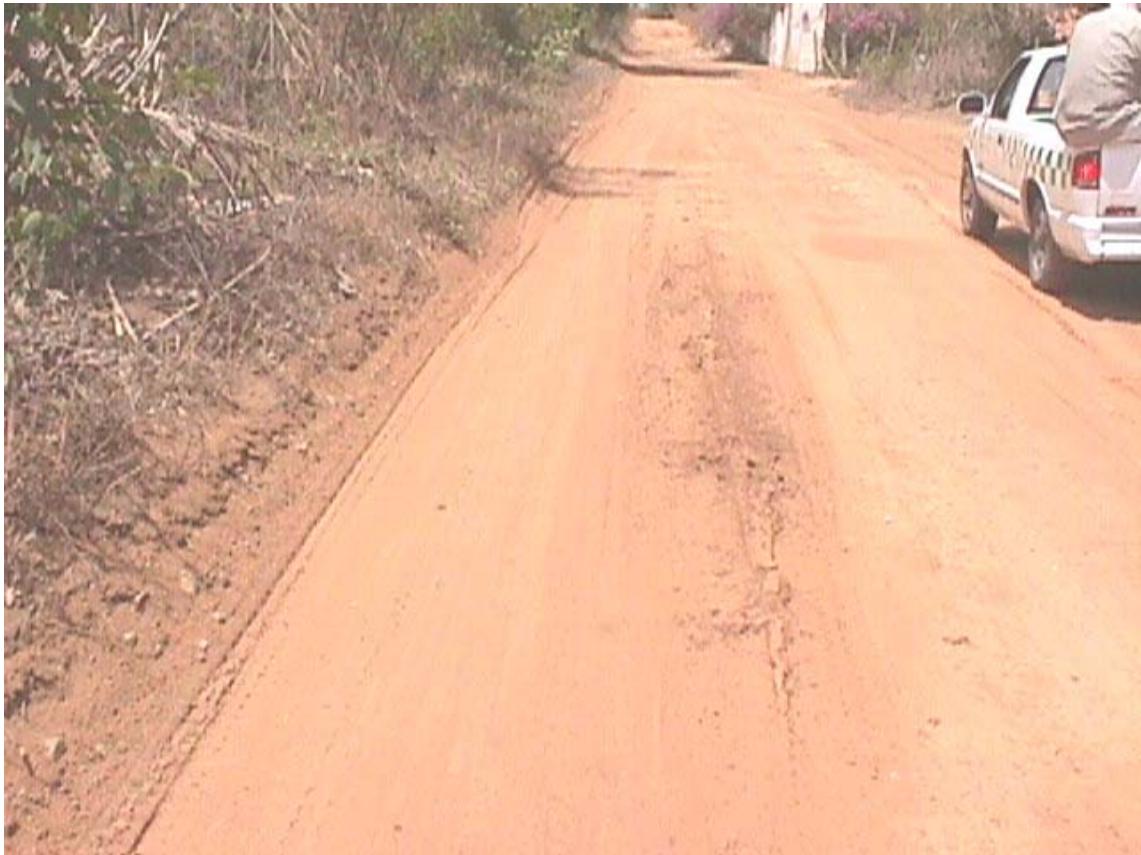
Figura 3.8: Ocorrência de Perda de Agregados com Formação Lateral e Central de Bermas.
