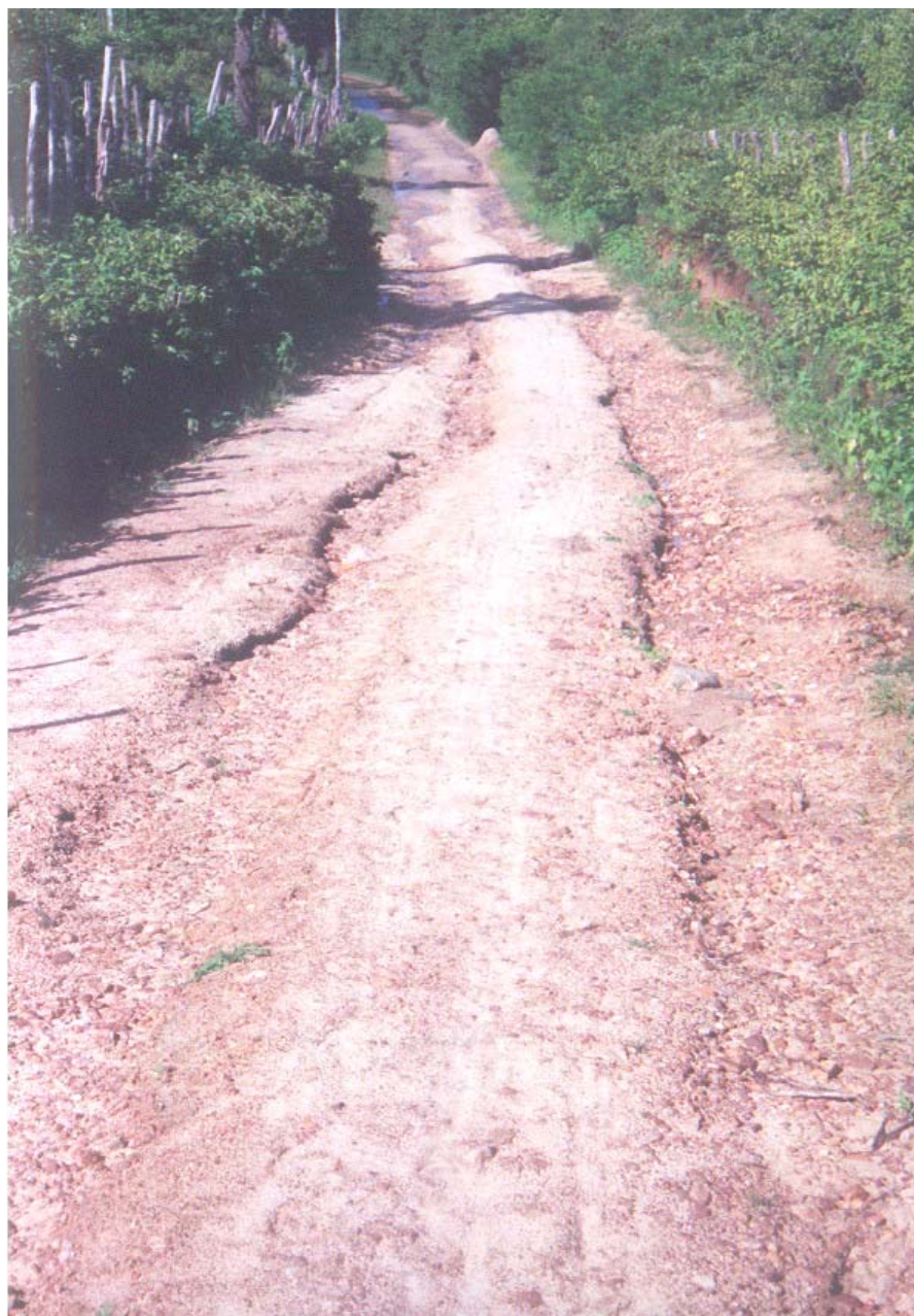
Figura 5.34: Erosão na Trilha de Roda Causada pela Ação do Escoamento da Água
