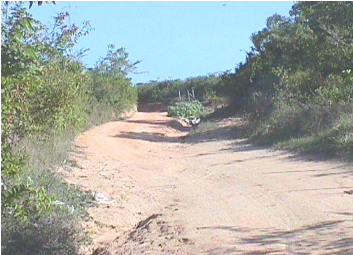
Figura 3.7: Ocorrência de Erosão, que Atravessa a Estrada.
