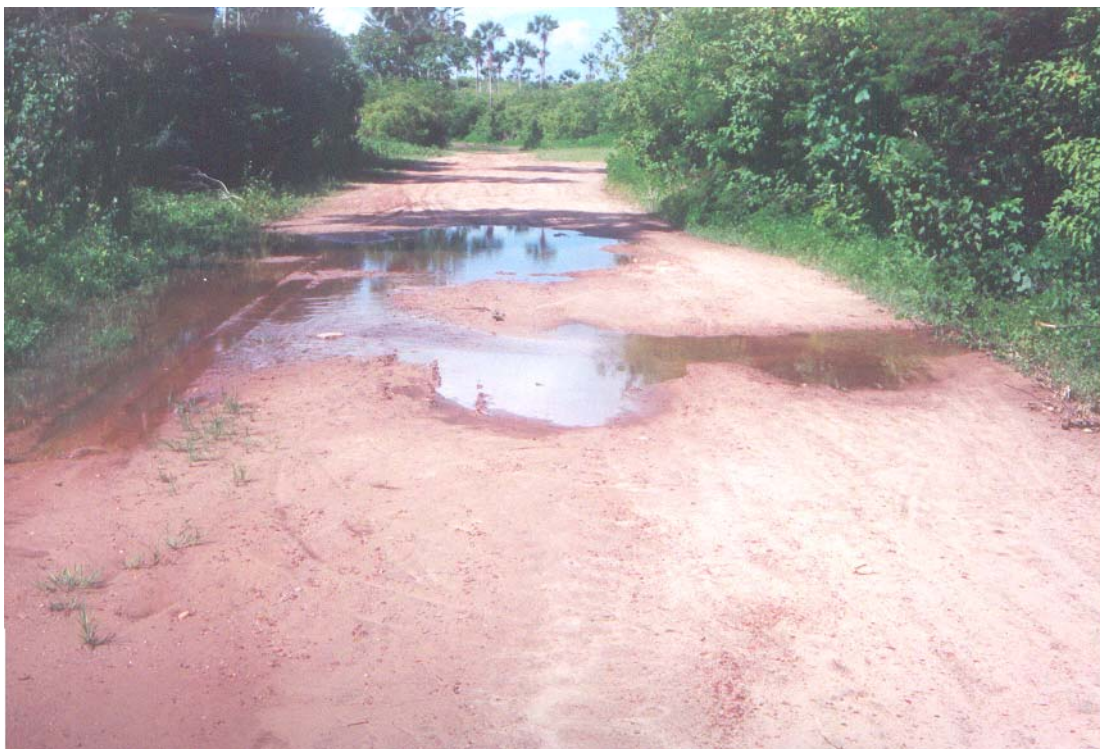
Figura 5.32: Empoçamento de Água Devido a Densificação da Vegetação e ao Tipo de Material Geotécnico que Contém Fração Argilosa
