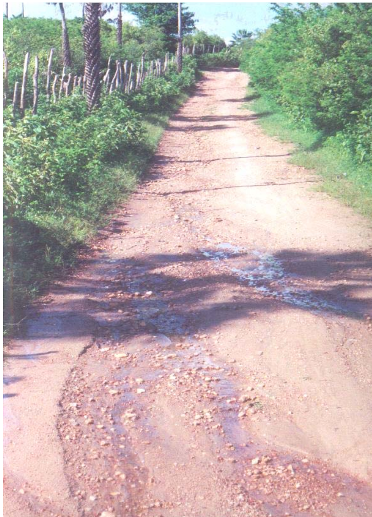
Figura 5.33: Erosão Causada pelo Escoamento Longitudinal da Água
