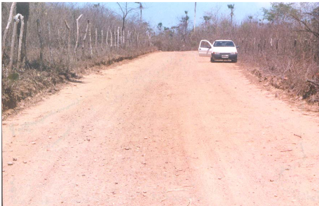
Figura 5.37: Seção Transversal Inadequada (Seção “Encaixada”).
