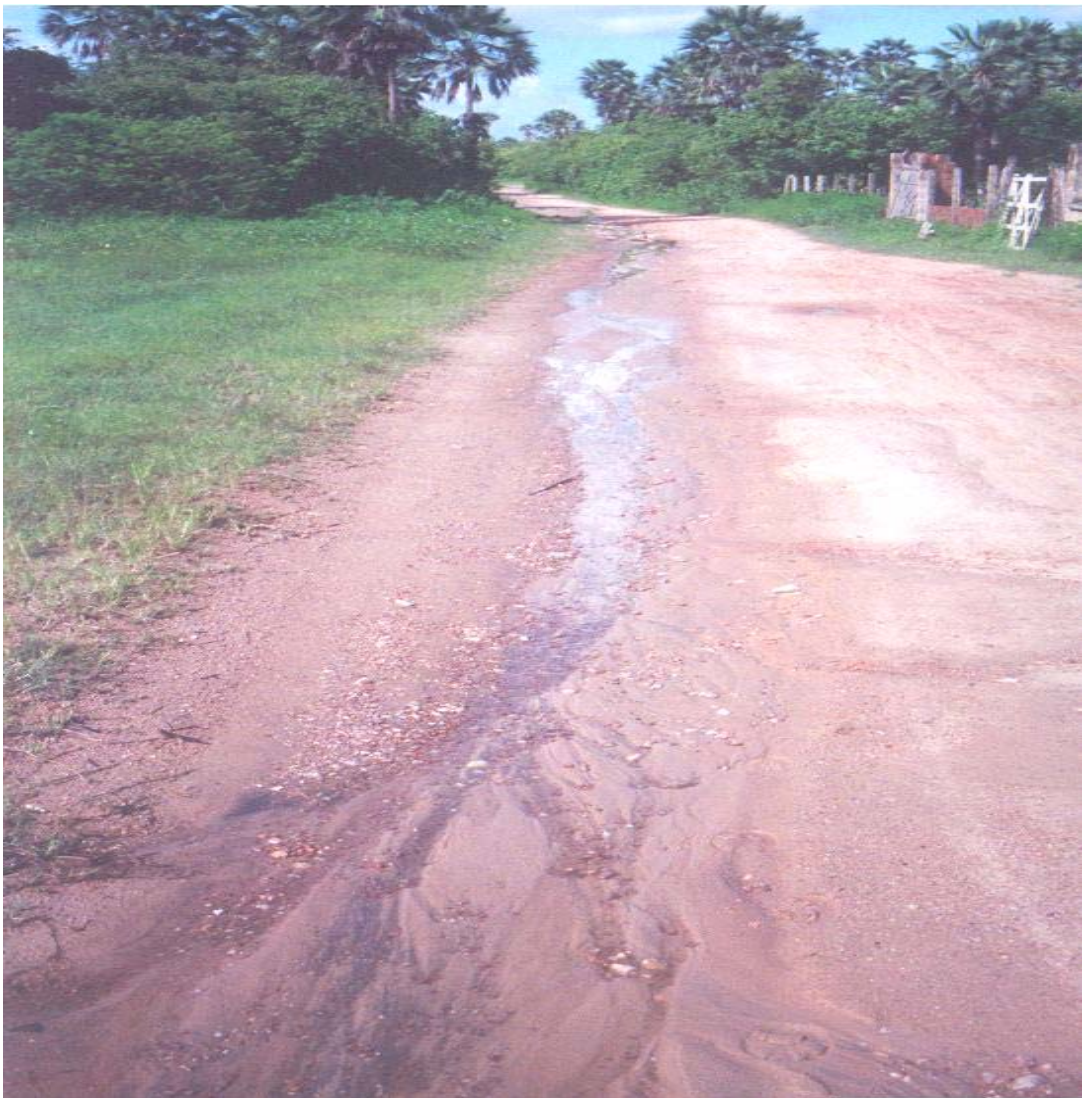
Figura 5.31: Escoamento Longitudinal da Água Devido à Invasão do Corpo Estradal pela Vegetação Lindeira
