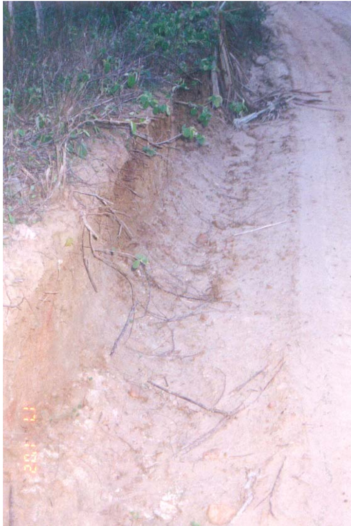
Figura 5.35: Erosão do “Pé do Corte” da Seção “Encaixada”.
