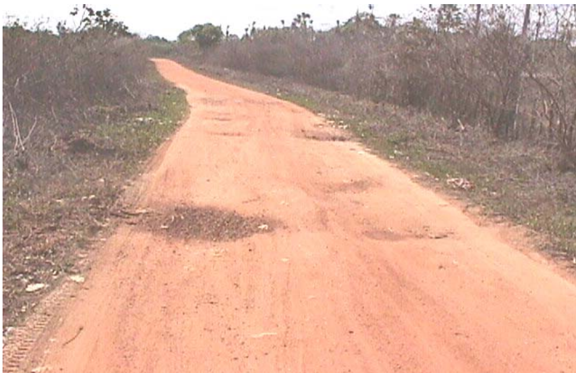
Figura 3.5: Ocorrência de Buracos ou Panelas.
