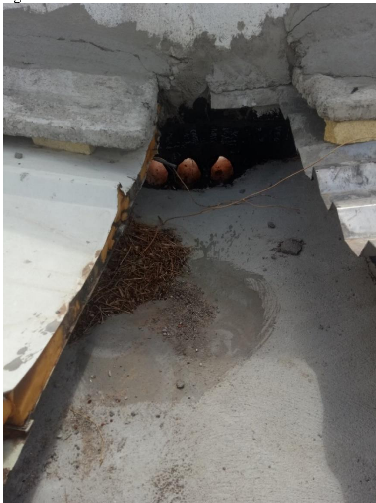
Figura 21 – Tubos de saídas laterais – Bloco Administrativo
