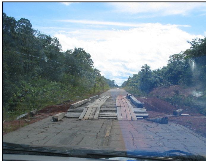
Figura 3. 6: BR 319 / km 200 – Revestimento trincado.
