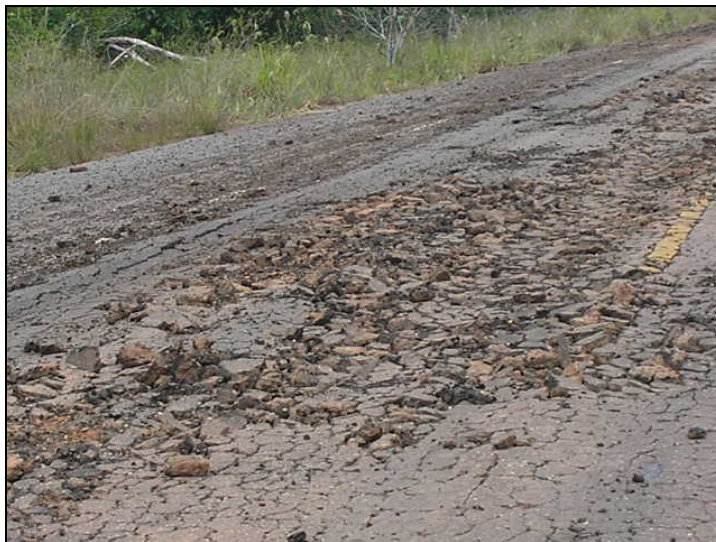
Figura 3. 4: BR 319 / km 150 – Revestimento deteriorado.
