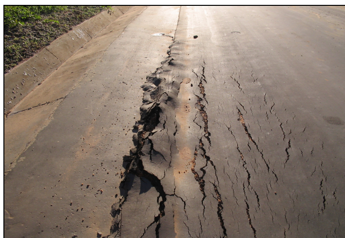
Figura 3. 7: Província de Urucu - AM – Revestimento comprometido.
