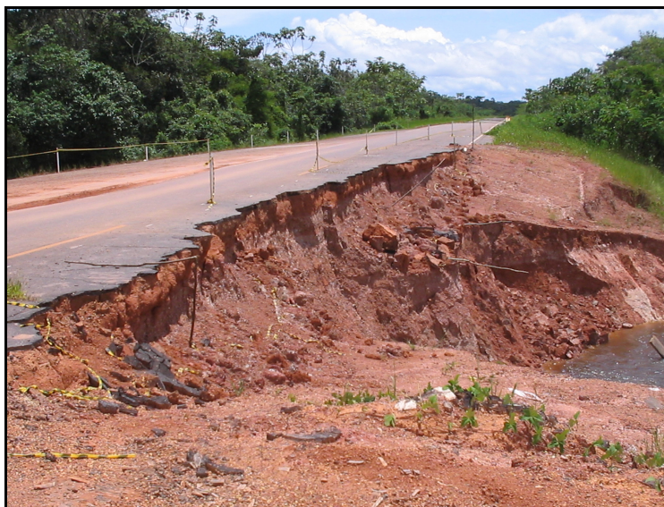
Figura 3. 3: BR 319 / km 23 – Trecho com erosão.
