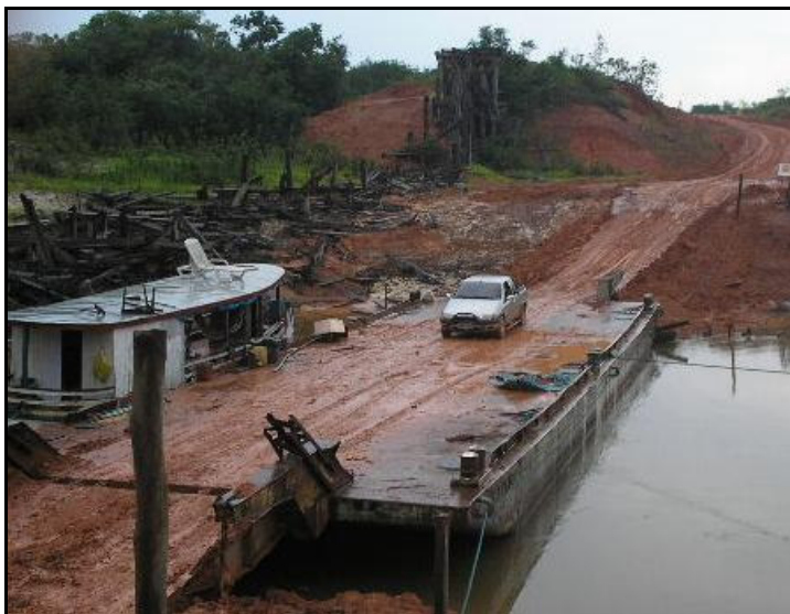
Figura 3. 5: BR 319 / km 178 – Ponte de madeira deteriorada.
