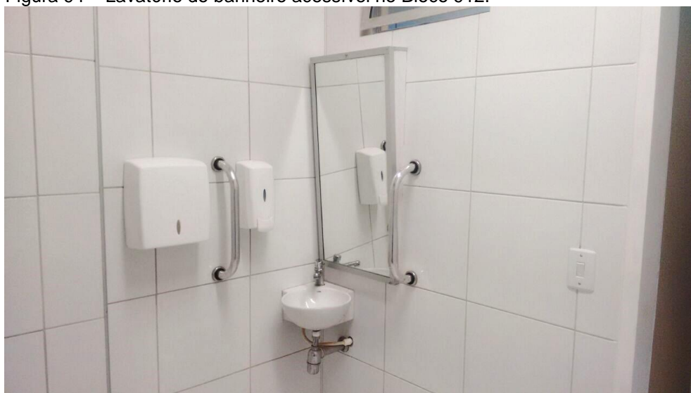
Figura 94 – Lavatório do banheiro acessível no Bloco 912.
