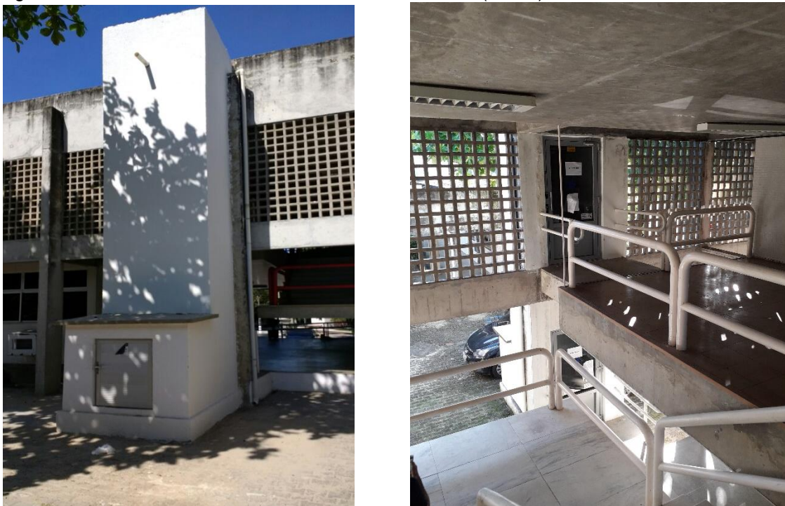
Figura 92 - Caixa externa da plataforma do Bloco 902 - Centro de Ciências (esquerda). Figura 93 - Plataforma do Bloco 902 - Centro de Ciências (direita).
