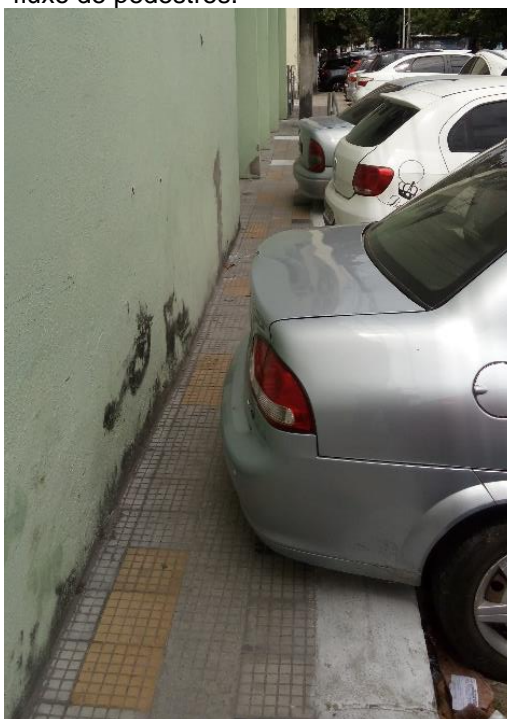
Figura 28 - Estacionamento na Rua Coronel Nunes de Melo inviabilizando o fluxo de pedestres.
