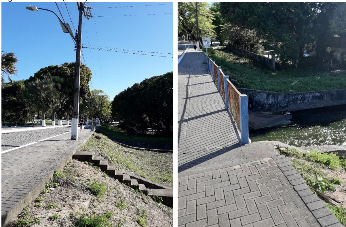
Figura 77 - Risco de queda em calçada próxima ao Açude Santo Anastácio (esquerda). Figura 78 – Idem (direita).
