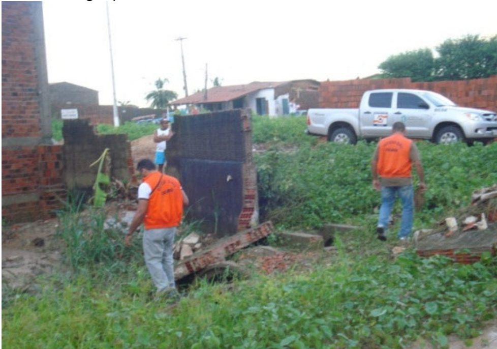
Figura 15 - Muro destruído por inundação em março de 2009 no bairro Novo Maranguape I
