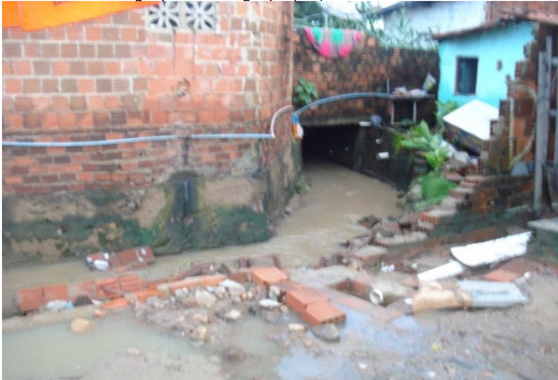
Figura 13 - Registro de muro atingido por inundação em março de 2009 no bairro Novo Maranguape I, Maranguape (CE)
