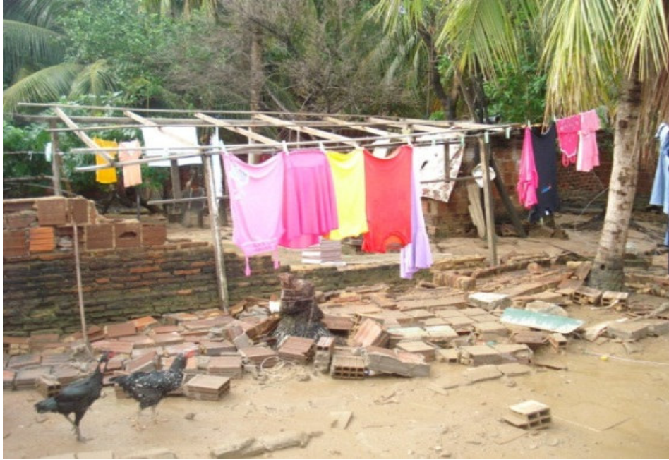
Figura 14 - Desabamento de muro em virtude de episódio de inundação no bairro Novo Maranguape I em 2009
