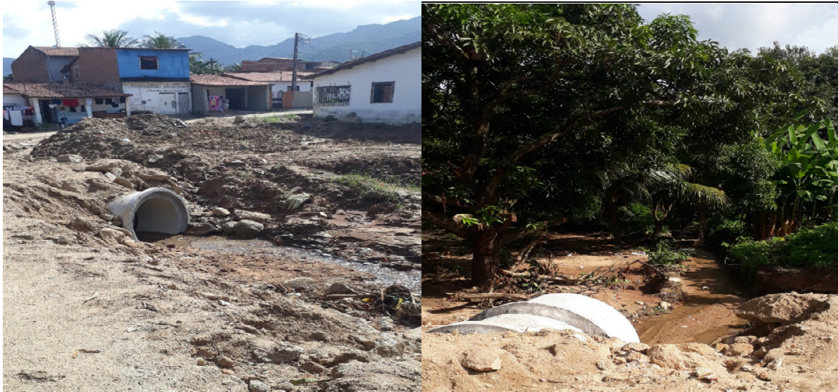
Figura 35 - Presença de manilhas (subdimensionadas) em trechos de rio no bairro Outra Banda
