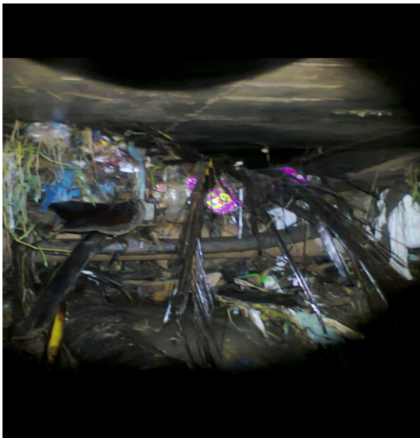
Figura 37 - Forte presença de lixo dentro de um canal no Novo Maranguape I
