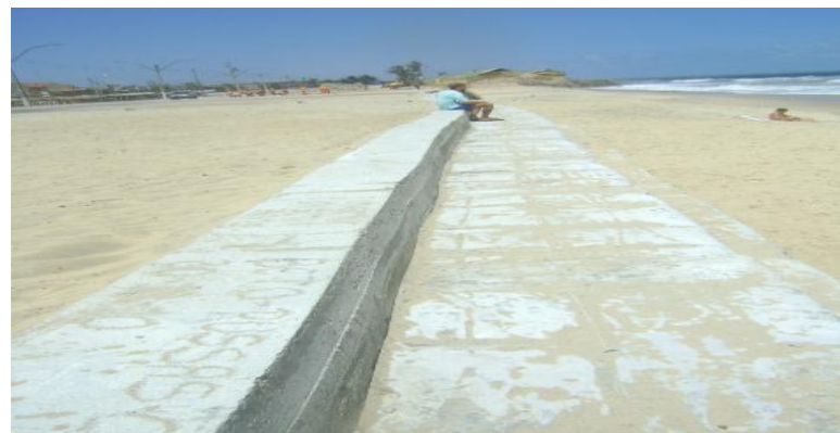
Foto 17. Construção do barra mar dissipador de energia do tipo Bag Wall na praia do Icaraí – Caucaia (Novembro/2010). UTM - 536649/9594274.
