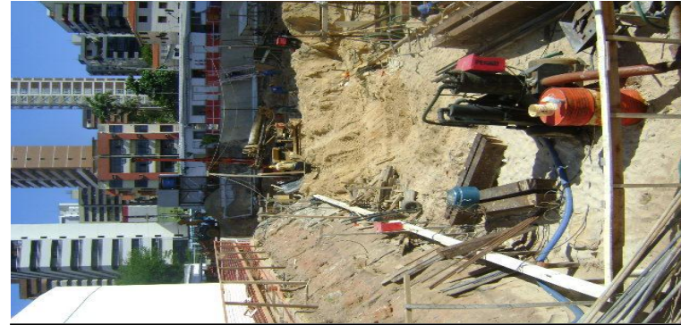
Foto 9. Equipamentos de rebaixamento do lençol freático em obra na Av. Beira Mar esquina com a Rua Silva Paulet (Outubro/2010). UTM – 555300/9588328.
