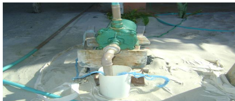
Foto 4. Poço tubular raso (6m de profundidade) instalado precariamente com bomba centrífuga, praia do Batoque (Outubro/2010). UTM - 588561 /9557670
