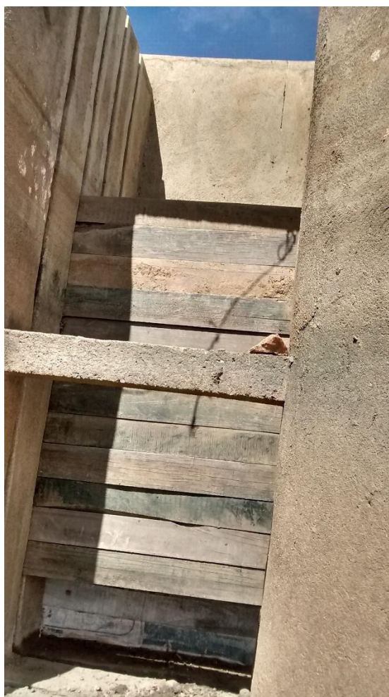
Figura 8 – comporta de drenagem com as tábuas de nível instaladas
