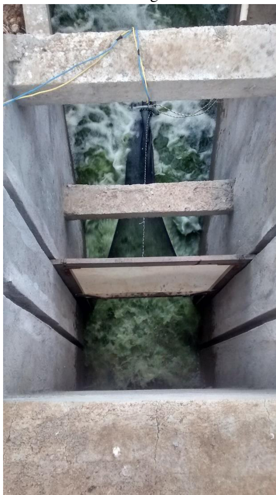
Figura 18 – Retirada de tábuas de nível e instalação da rede de contenção na comporta de drenagem do viveiro.
